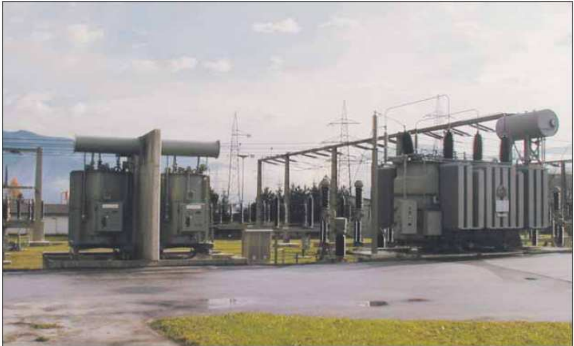
Figura 3.14 - Vista de subestação 110/20 kV com bobina de supressão de arco.
