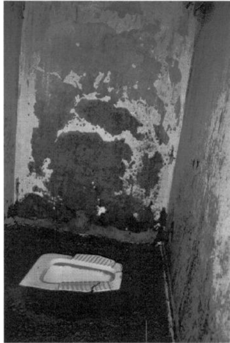
Fotografia 12 – Bloco 3, Ala C. Banheiro com paredes permeáveis. Bacia turca danificada.
