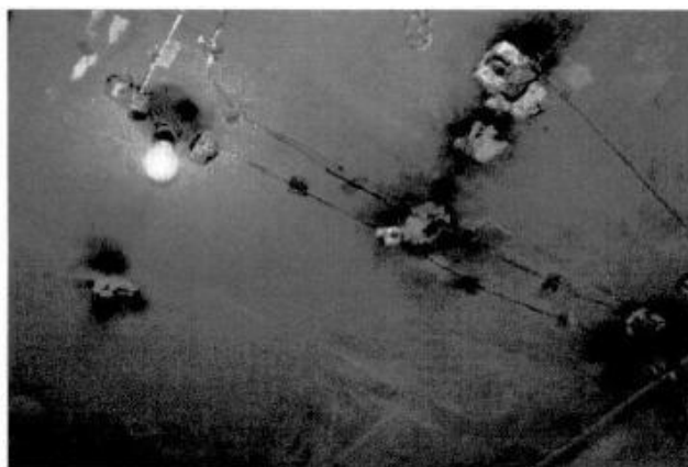
Fotografia 7 – Cella do Bloco 2. Fios condutores desprotegidos feitos pelos internos com metal proveniente das “quentinhas”.
