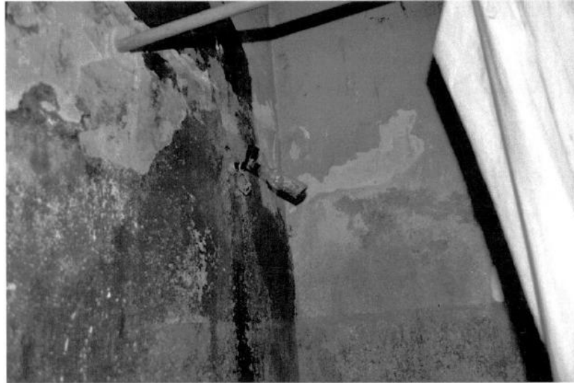
FOTOGRAFIA 3 – CDP, BLOCO 1, ALA A, CELA 8 – BANHEIRO DA CELA. ESTRUTURA DECRÉPITA E DETERIORADA. BOCAL DE CHUVEIRO IMPROVISADO. MESMA SITUAÇÃO OBSERVADA EM VISTÓRIAS DE 2015.
