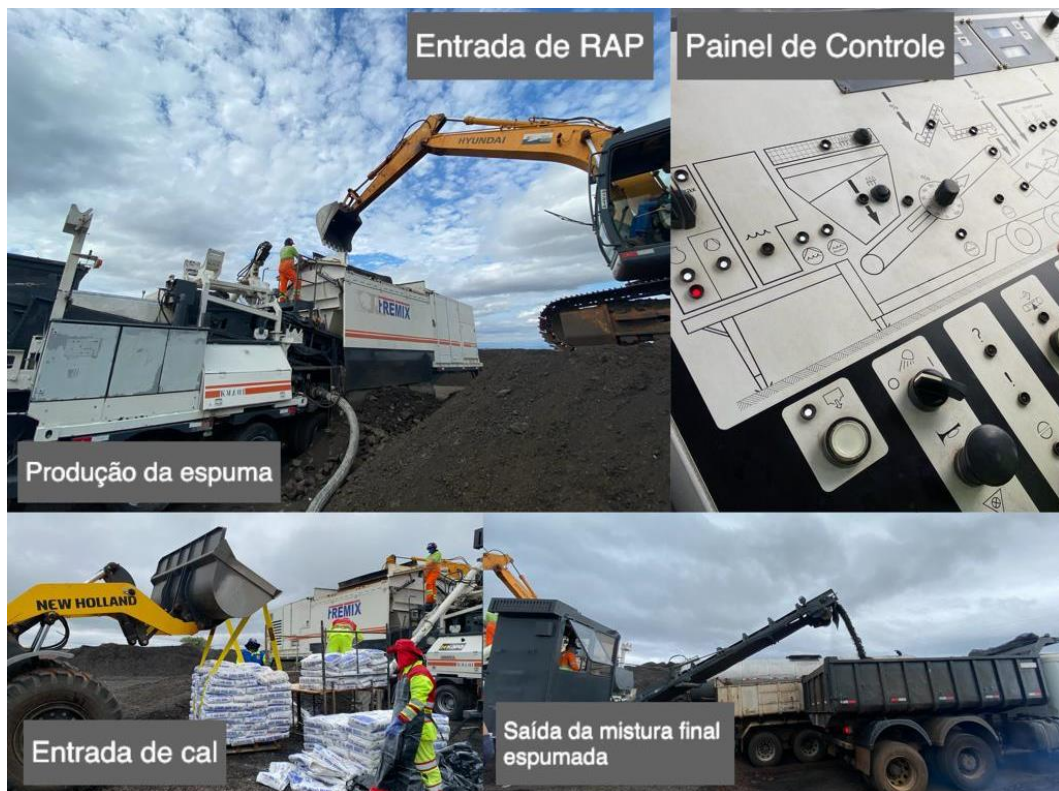
Figura 2-5 – Usina Móvel KMA 220.
