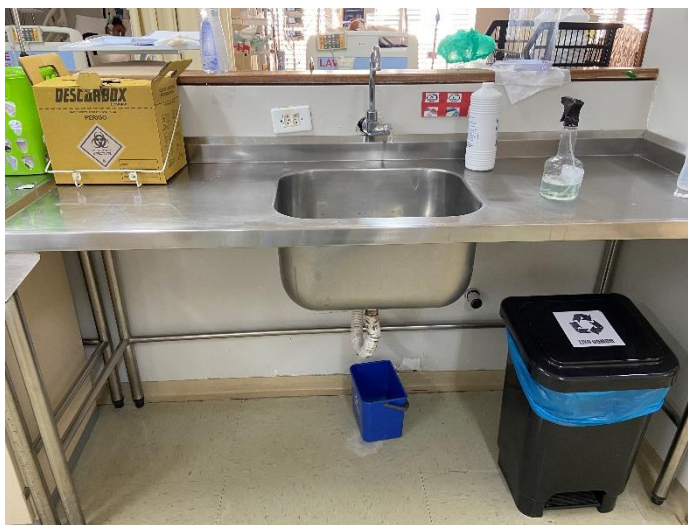
FIGURA 135 - ÁREA DE PIA DA BANCADA PARA PREPARO DE MEDICAMENTOS DA UTI
