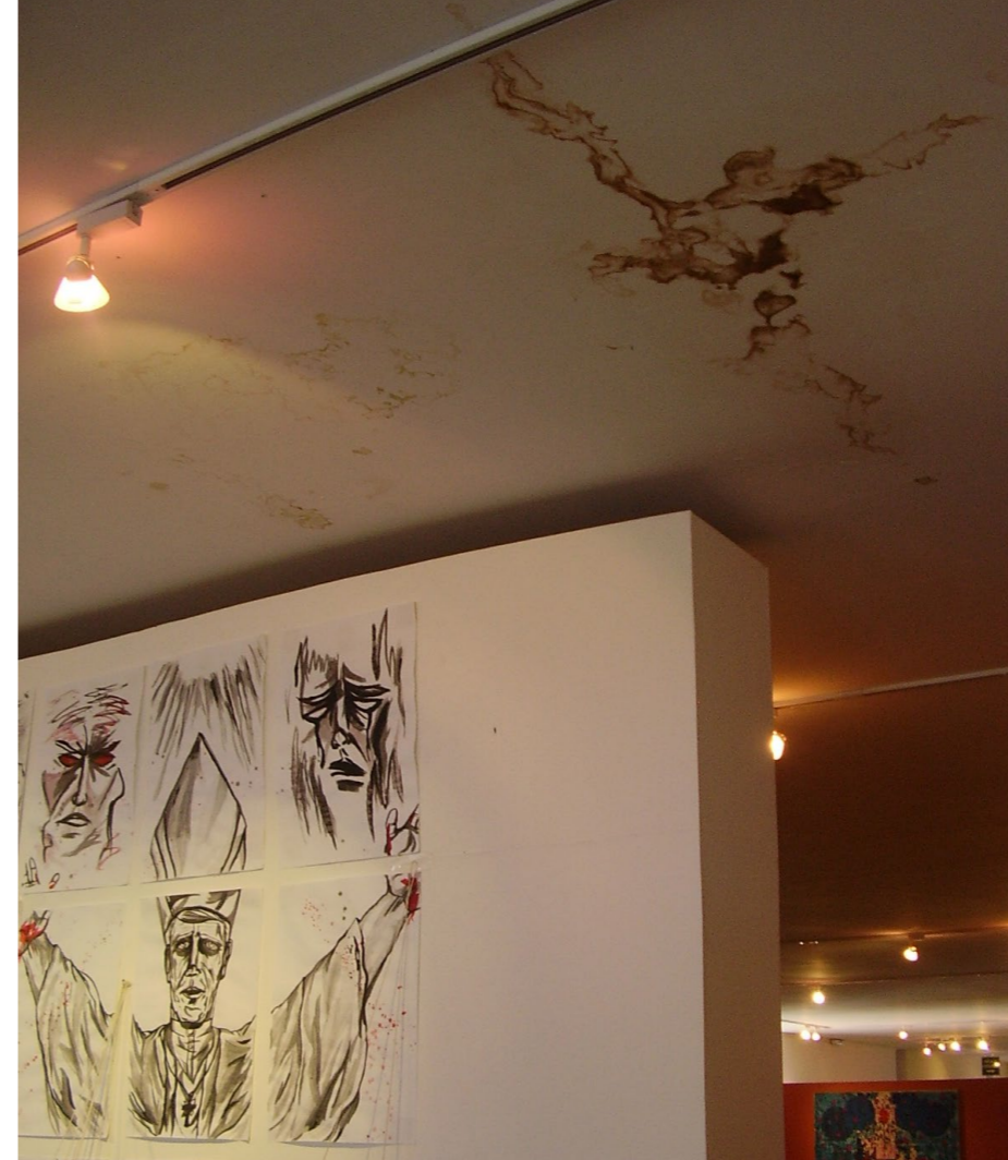
39. Infiltrações visíveis no salão de exposições durante a mostra Artessários , 2006.
