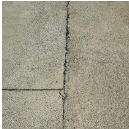
Figura 5: Desgaste superficial e esborcinamento de junta, amostra Região 02
