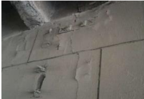
Figura 4 - Fissura de tração no encontro. Fonte: Quaresma e Cardoso [20].
