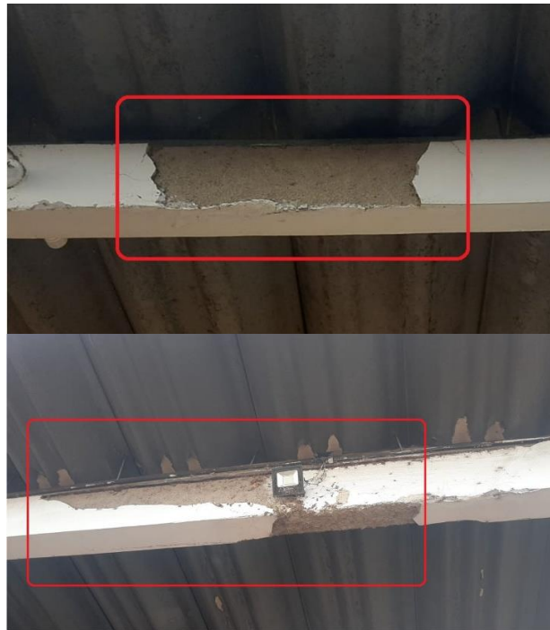
Figura 10 - Deslocamento de revestimento argamassado e parte do concreto em vigas, contribuindo para uma maior exposição da armadura e perda de durabilidade da estrutura
