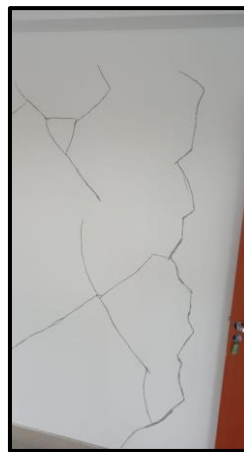
Figura 2. Revestimento fissurado (Obra 2).
