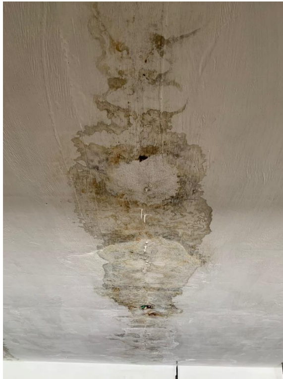
Figura 7 – Infiltrações no teto do pavimento garagem com formações de estalactite
