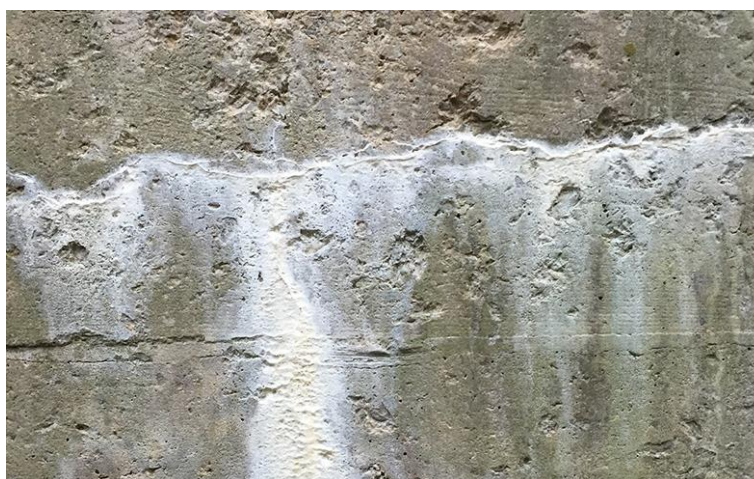
Figura 2 – Eflorescência em parede de alvenaria [6]
