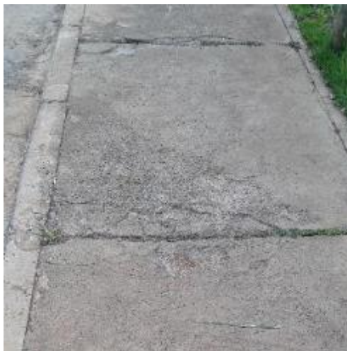
Figura 8: Calçada degradada, amostra região 04.
