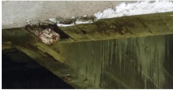
Figura 2 – Corrosão na armadura. Fonte: Macedo [17].
