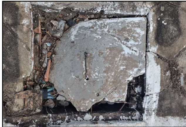
Figura 6 - Estado de conservação das caixas de inspeção
