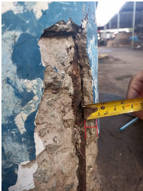
Figura 7 – Cobrimento inadequado dos pilares, ocasionando menor proteção à armadura.
