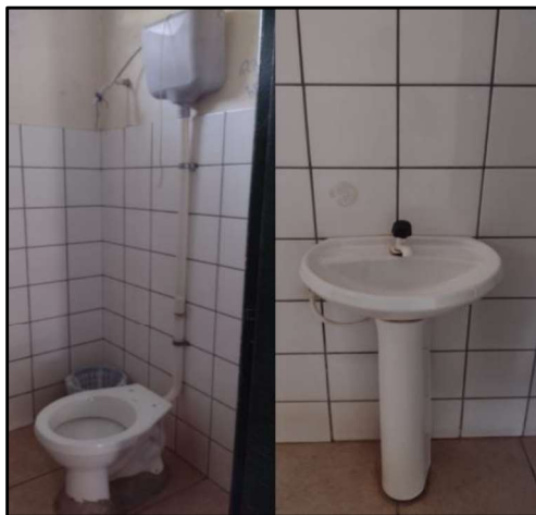
Figura 13 - Acessórios sanitários dos banheiros da praça
