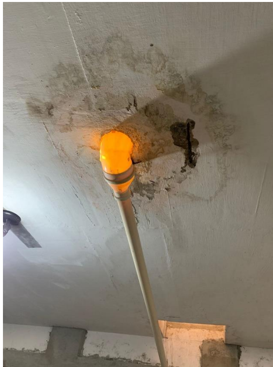
Figura 8 – Infiltração e exposição de armadura no teto do pavimento garagem
