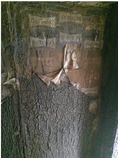
Figura 6 – Danos da manta asfáltica estudada.
