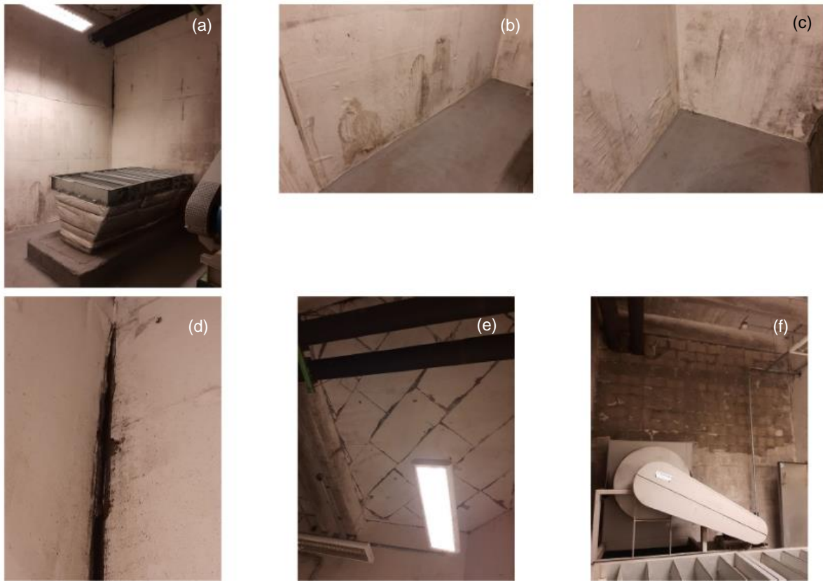
Figura 5 – Locais dentro da central de ar condicionado com manchas de desenvolvimento de microrganismos e manchas de umidade.
