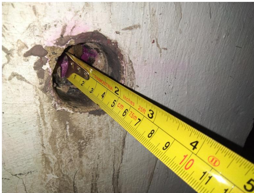
Figura 7 - Medição da frente de carbonatação
