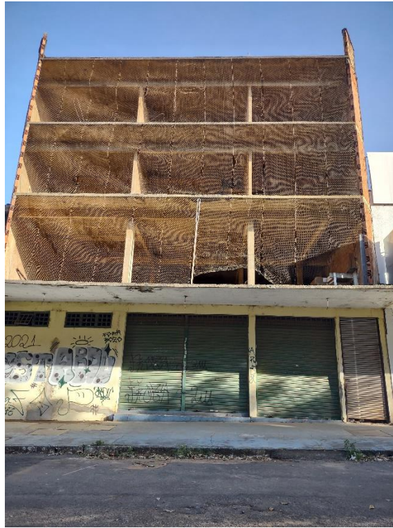
Figura 16 - Edifício abandonado, caso 5.
