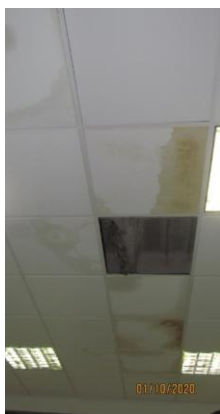
Figura 15 – Mancha de umidade forro e deslocamento ocorridos na sala 1.
