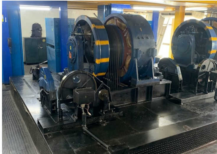
FIGURA 18 MOTORES ELÉTRICOS COM ALTO CONSUMO DE ENERGIA DOS ELEVADORES FONTE Autoria própria
