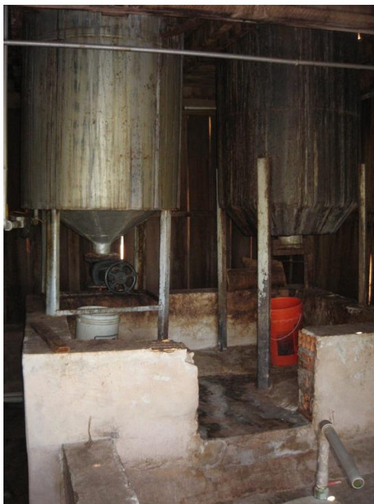
Figura 15. Dois cozinhadores que são alimentados pelo vapor da caldeira, usados no processamento das fibras.
