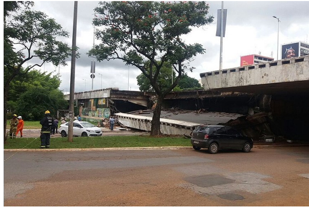
(a) Viaduto que desabou no centro de Brasília, em 2018.
