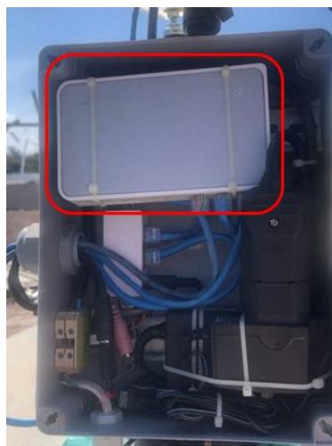
Figura 39: Switch Ethernet instalado no quadro de equipamentos elétricos/eletrônicos do tripé da câmera 1, por estar mais próximo de um ponto de alimentação de energia.
