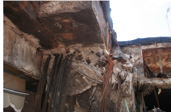
b) Ruptura dos cabos de protensão do pilar.
