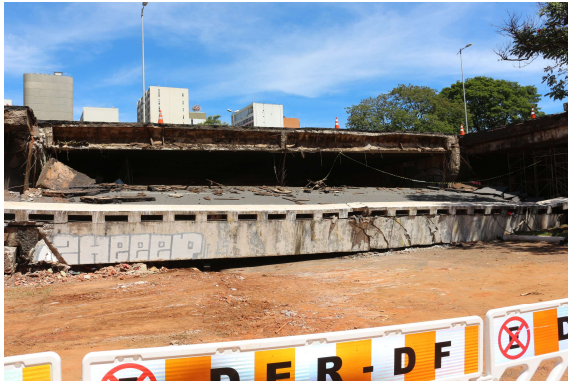
a) Ruptura do tabuleiro.
