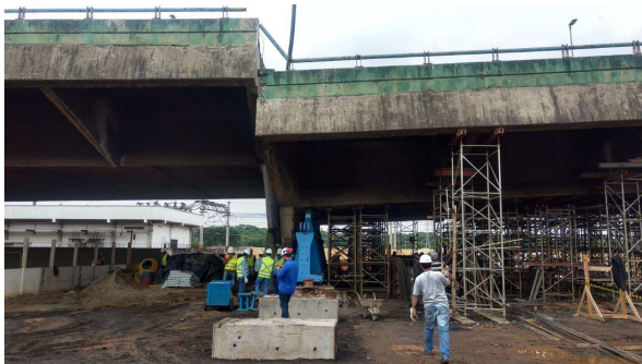
a) Ruptura do tabuleiro.
