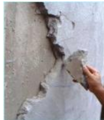
(d) Descolamento da argamassa. Fonte: Base de dados Bauer (2018)
