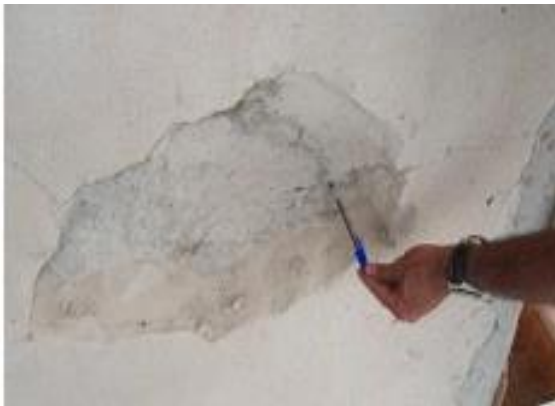
(c) Descolamento da argamassa. Fonte: Base de dados Bauer (2018)
