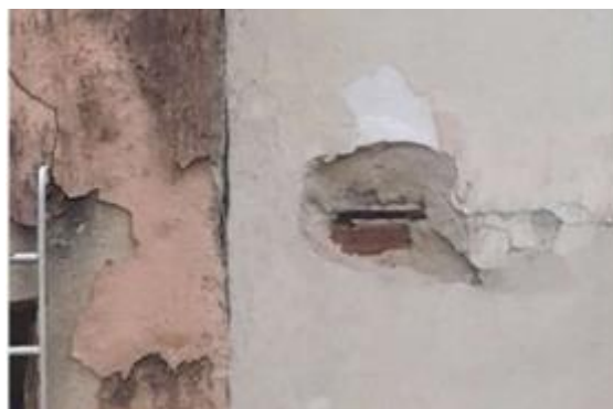
Figura 6.19: Descolamento da fachada – Nível de gravidade 3 Fonte: Júnior (2020)
