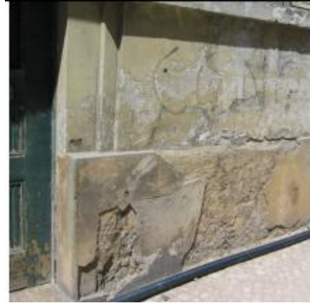
(b) Descolamento da argamassa. Fonte: Gaspar (2009)
