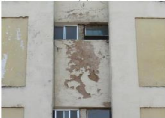
(a) Pulverulência nas fachadas. Fonte: Santos (2018)
