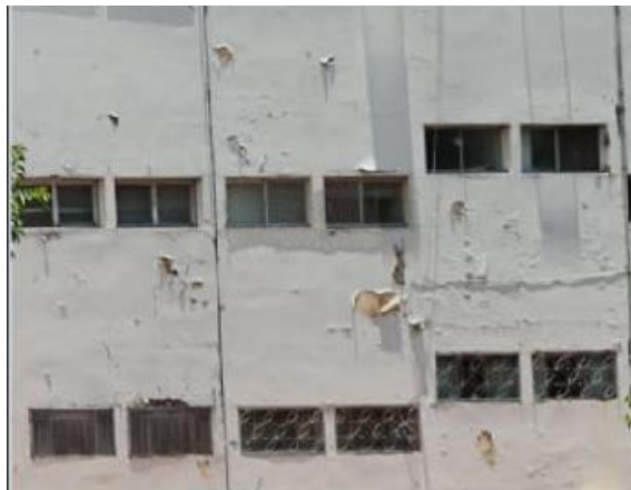
(e) Pulverulência nas fachadas. Fonte: Banco de Dados Bauer (2023)
