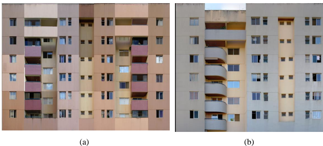
(a) (b) Figura 6.15: Manchas com nível de gravidade 1 Fonte: Base de dados Bauer (2018)
