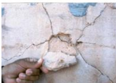
Figura 6.20: Descolamento da fachada – Nível de gravidade 4 Fonte: Base de dados Bauer (2018)
