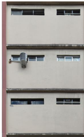
Figura 6.18: Descolamento da fachada – Nível de gravidade 2 Fonte: Base de dados Bauer (2018)
