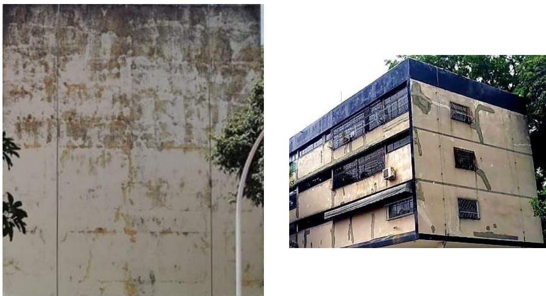
Figura 6.14: Fissuras classificadas com nível de gravidade 4
