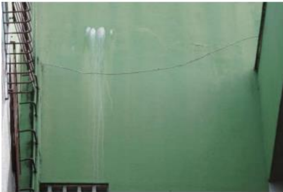
(c) Eflorescência nas fachadas Fonte: Júnior (2020)
