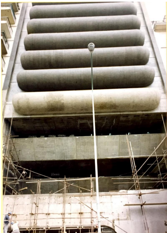
Figura 147: Fotografia mostrando a finalização das obras na fachada principal do projeto. Fonte: SARQ/MRE.
