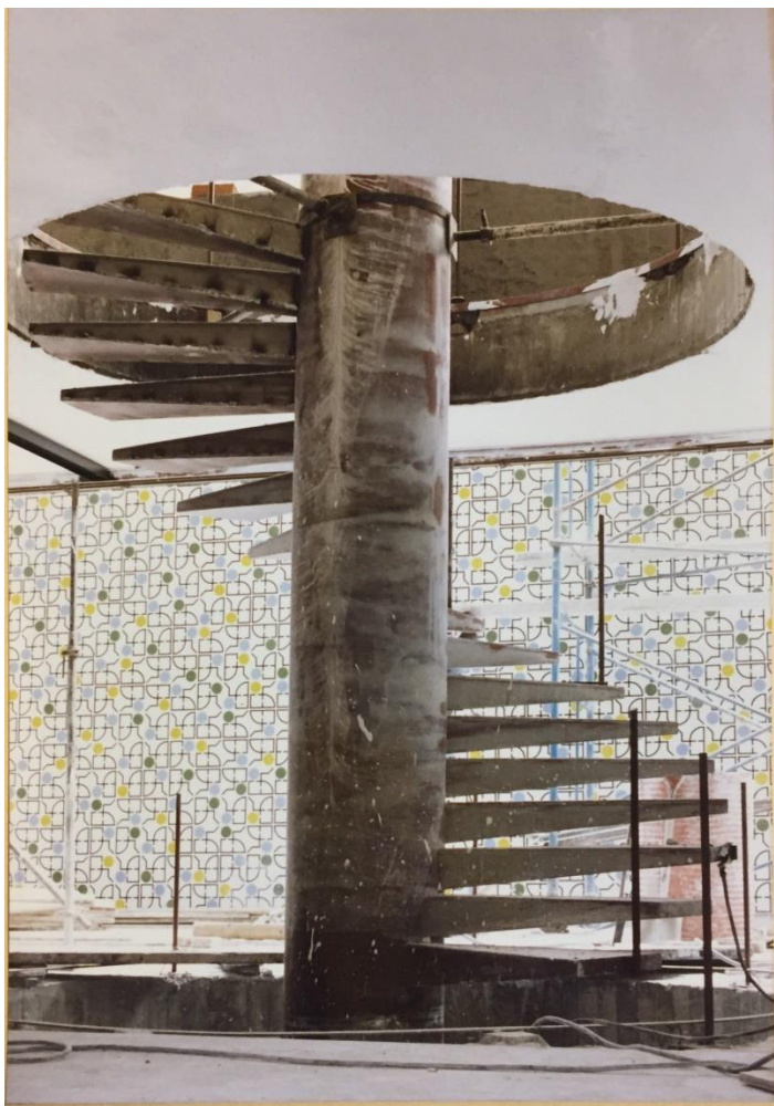
Figura 151: Detalhe da concretagem da escada helicoidal, ainda sem corrimãos. Fonte: Acervo do SARQ/MRE.
