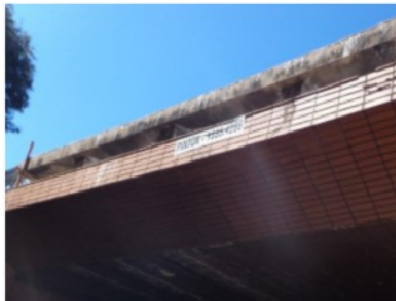
Figura 123.a - E.A.R - Guarda Roda Danificado
