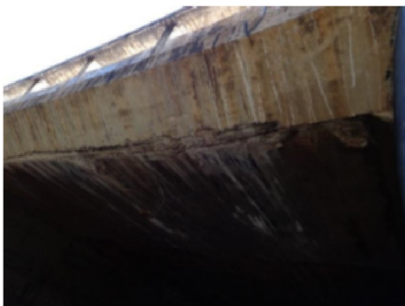
Figura 288.a - E.A.R Exposição e corrosão de armadura do viaduto
