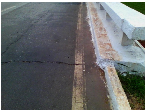
Figura 22.a - Fissura na junta de dilatação
