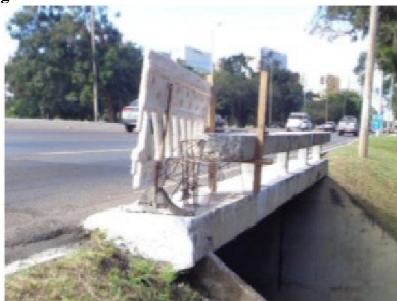
Figura 219.a - E.A.R - Guarda Roda Danificado
