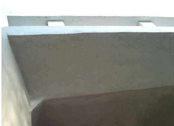
Figura 127.b – E.AP.R Junta da cortina de concreto
