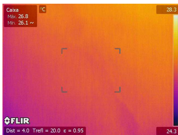
Figura 163.d - TM.P.U - Termográfica laje
