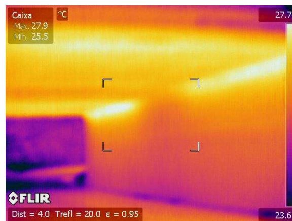
Figura 236.d - TM.P.U - Termográfica Tabuleiro
