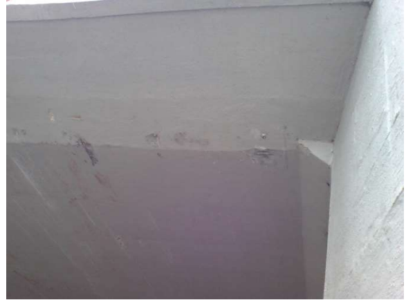
Figura 246.b – E.AP.R Junta da cortina de concreto
