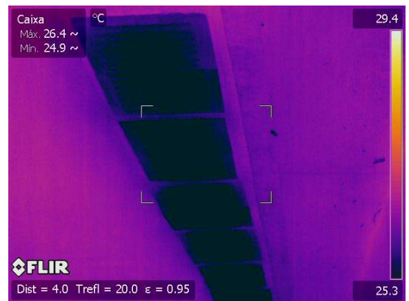
Figura 352.c - TM.P.S - Termográfica passagem de pedestre
