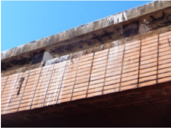
Figura 98.a - E.A.R - Guarda Roda Danificado
