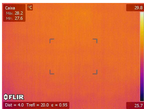
Figura 231.c - TM.P.S - Termográfica laje
