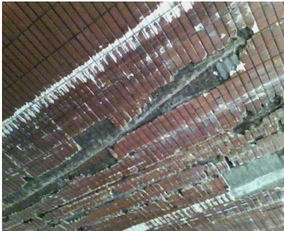
Figura 16.a - Abrasão do concreto na laje
