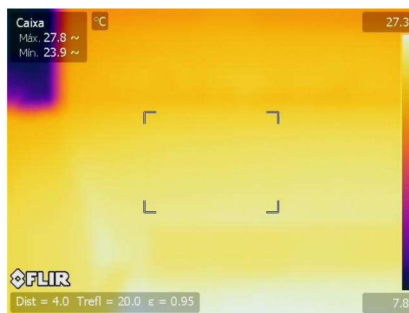
Figura 280.c - TM.P.S - Termográfica guarda roda
