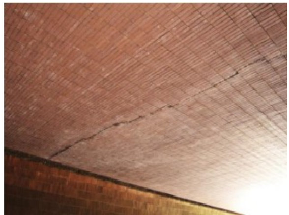
Figura 75.a - E.A.R - Detalhe de fissura em tesourinha sob o Eixo
