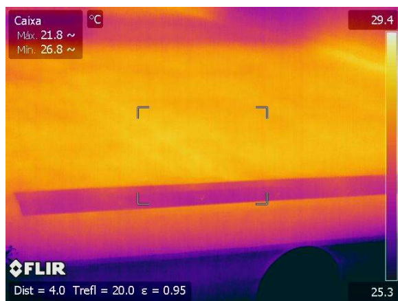
Figura 323.c - TM.P.S - Termográfica encabeçamento do viaduto
