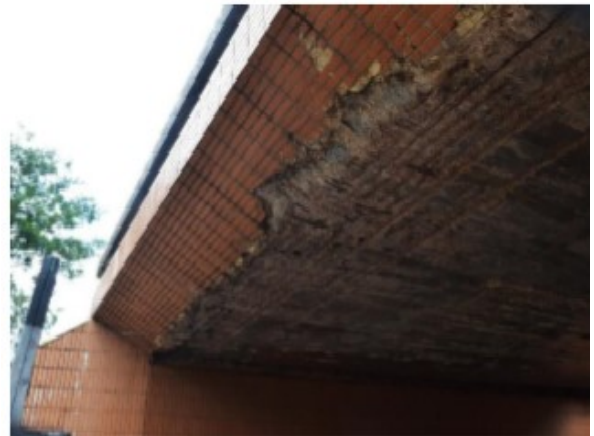
Figura 49.a – E.A.R – Revestimento deslocando
