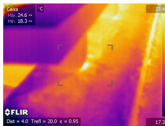
Figura 136.c – TM.P.S Termograma do Guarda roda
