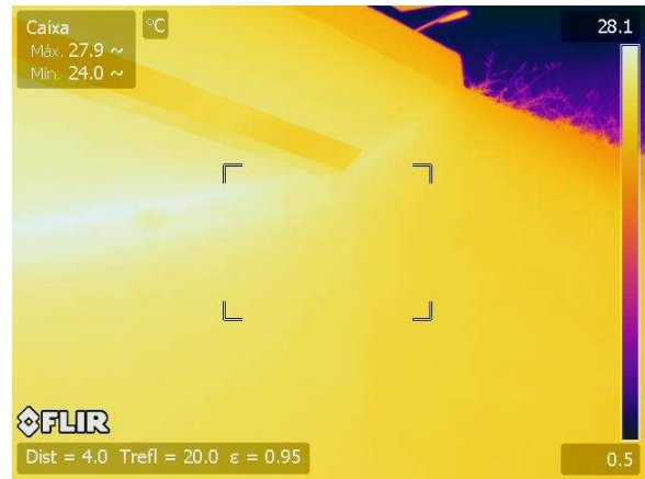
Figura 88.c - TM.P.S Termográfica junta da cortina
