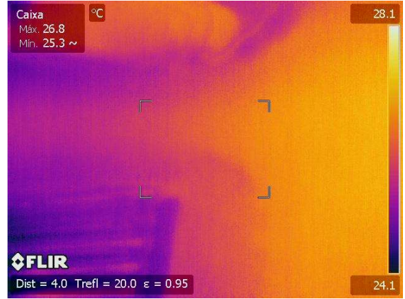
Figura 372.c - TM.P.S - Termográfica encabeçamento do viaduto
