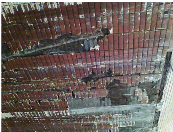
Figura 21.a - Armadura exposta na laje
