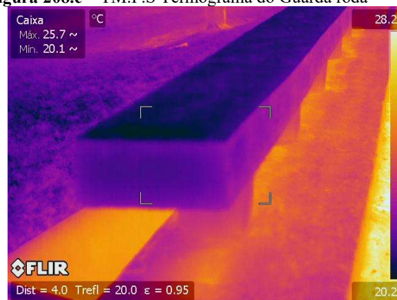
Figura 208.c - TM.P.S Termograma do Guarda roda
