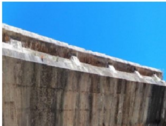
Figura 361.a - E.A.R Guarda roda danificado
