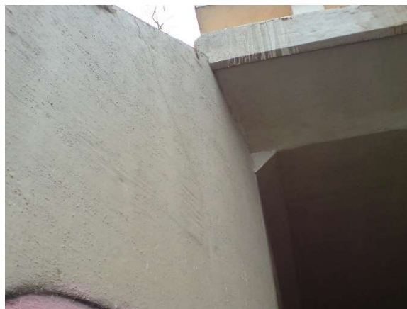
Figura 222.b – E.AP.R Junta da cortina de concreto
