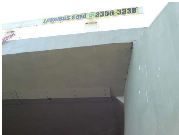
Figura 149.b – E.AP.R Junta da cortina de concreto
