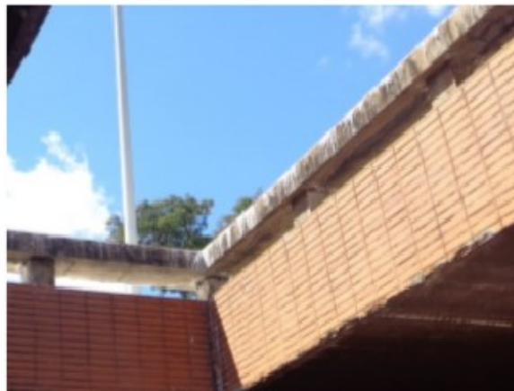
Figura 147.a - E.A.R - Guarda Roda Danificado
