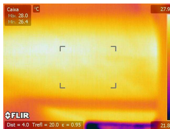
Figura 300.c - TM.P.S - Termográfica encabeçamento do viaduto
