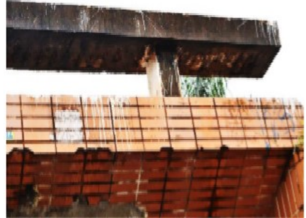
Figura 51.a - E.A.R - Guarda Roda Danificado
