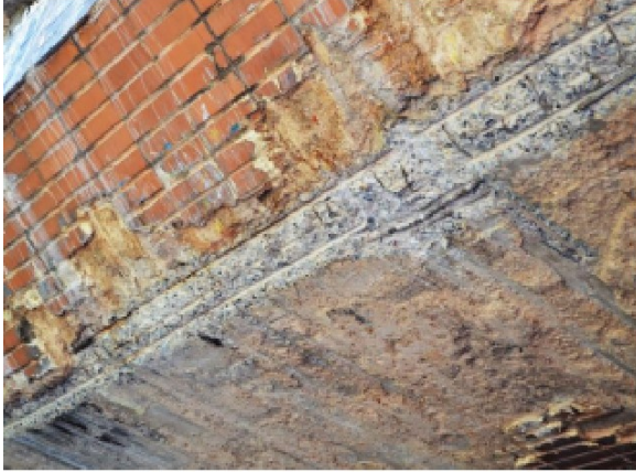
Figura 72.a – E.A.R – Revestimento deslocando
