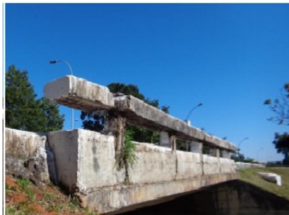
Figura 313.a - E.A.R Guarda roda danificado
