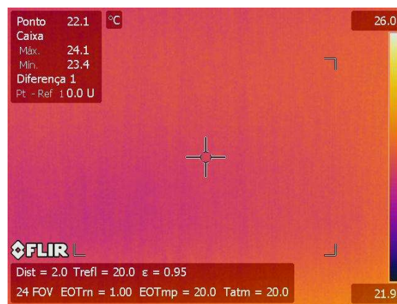
Figura 282.d - TM.P.U - Termográfica tabuleiro
