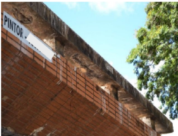
Figura 74.a - E.A.R - Guarda Roda Danificado
