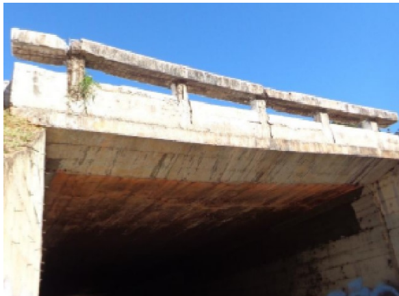
Figura 312.a - E.A.R Guarda roda danificado
