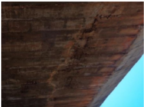
Figura 314.a - E.A.R Exposição e corrosão de armadura no viaduto
