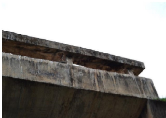
Figura 384.a - E.A.R Guarda roda danificado
