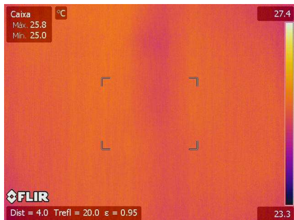
Figura 303.c - TM.P.S - Termográfica junta da cortina
