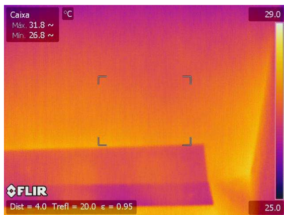
Figura 179.c - TM.P.S - Termográfica laje
