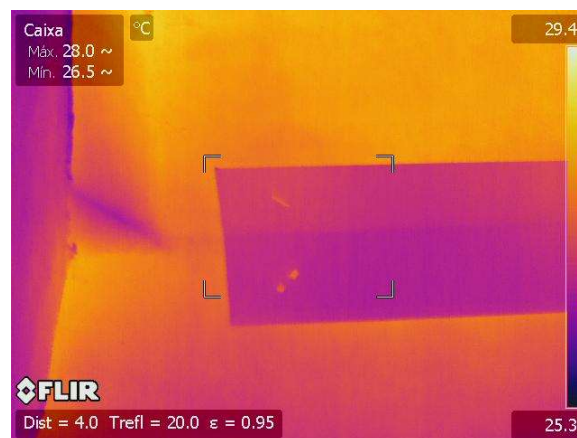
Figura 324.c - TM.P.S – Termográfica junta do encabeçamento
