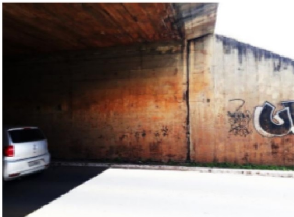
Figura 338.a - E.A.R Armadura exposta no encabeçamento e junta do viaduto
