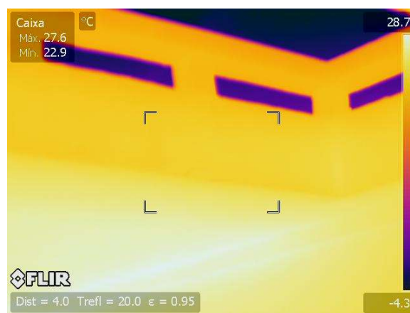
Figura 110.c – TM.P.S Termograma do Guarda-roda
