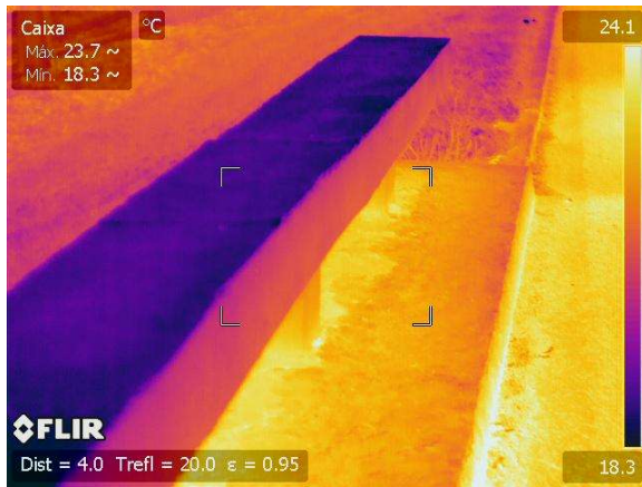
Figura 87.c - TM.P.S - Termográfica Guarda roda
