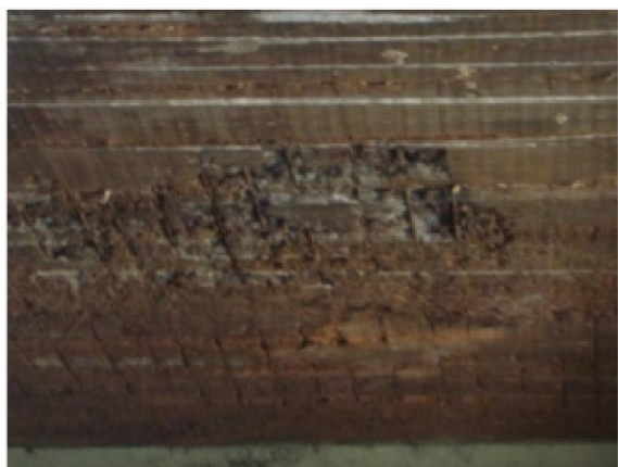
Figura 242.a - E.A.R Exposição e corrosão de armadura
