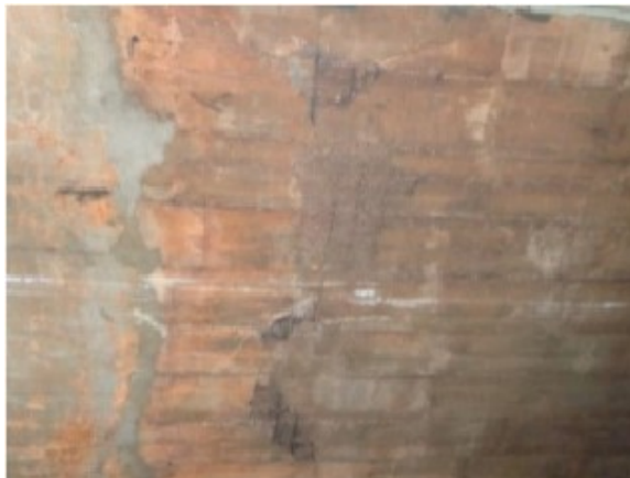
Figura 315.a - E.A.R Exposição e corrosão de armadura
