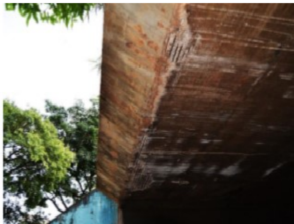
Figura 339.a - E.A.R Armadura exposta no encabeçamento
