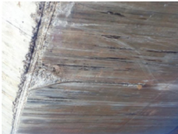
Figura 290.a - E.A.R Armadura rompida em encabeçamento do viaduto
