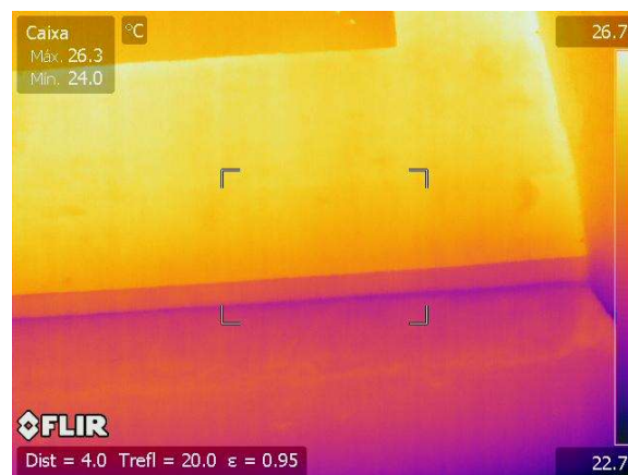
Figura 398.c - TM.P.S - Termográfica Guarda roda
