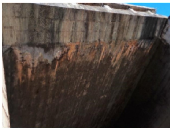
Figura 362.a - E.A.R Encabeçamento do viaduto com corrosão
