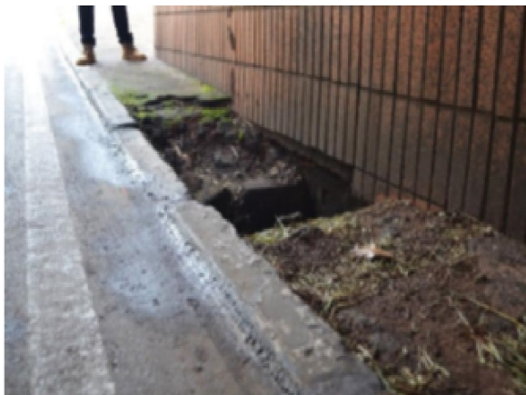
Figura 194.a – E.A.R calçada danificada próximo a ponto de drenagem do viaduto
