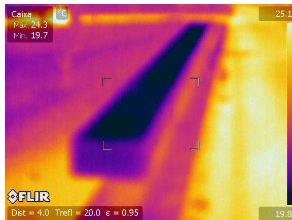
Figura 304.c - TM.P.S - Termográfica Guarda roda
