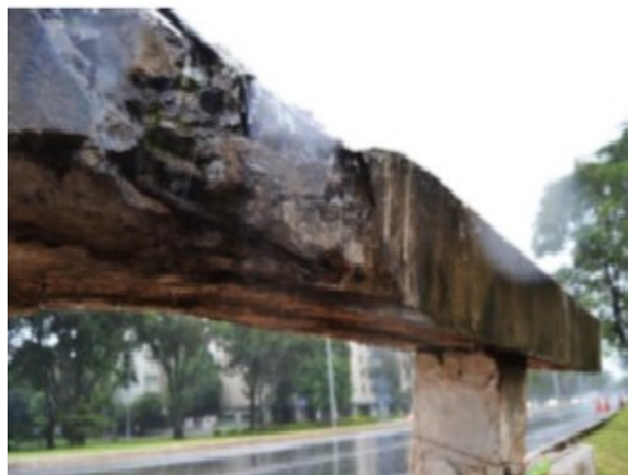
Figura 195.a - E.A.R - Guarda Roda Danificado
