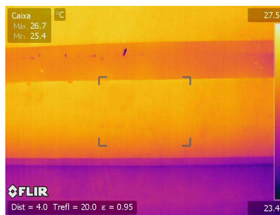
Figura 396.c - TM.P.S - Termográfica Passagem de pedestre
