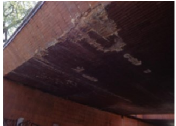
Figura 25.a – E.A.R – Revestimento deslocando do viaduto
