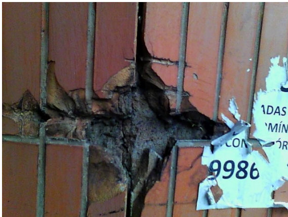
Figura 17.a - Fenda no revestimento lateral
