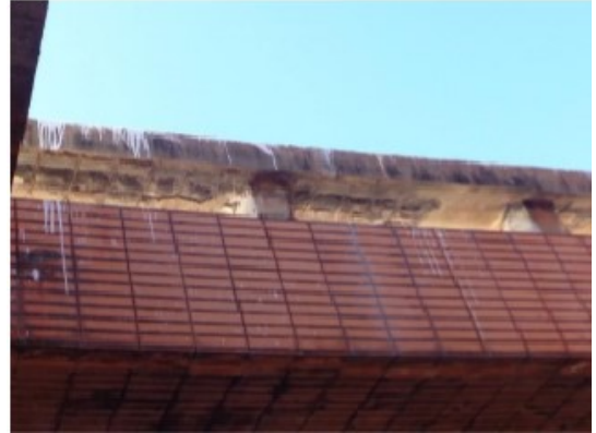
Figura 27.a - E.A.R - Guarda Roda Danificado
