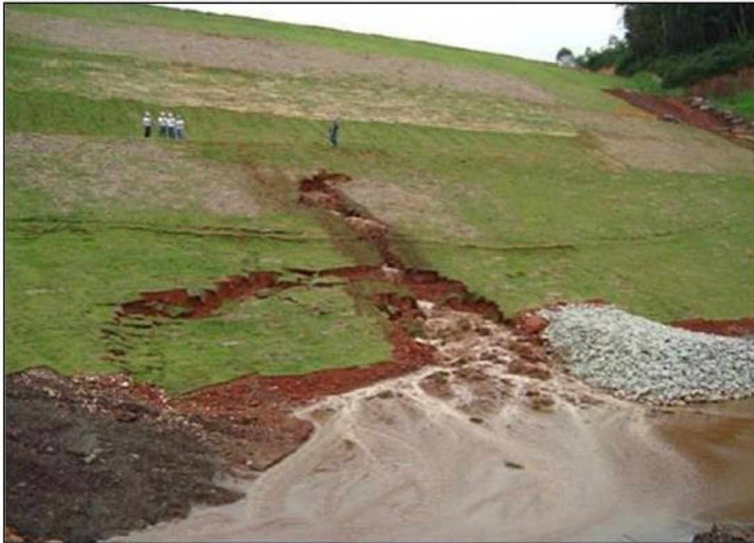
Figura 8: Imagem Danos à barragem de Fundão provocados por Piping ou erosão interna – 13/04/2009. Fonte: Fundão tailings dam review panel – Report on immediate causes of the failure of the Fundão dam, Ramboll (2017).
