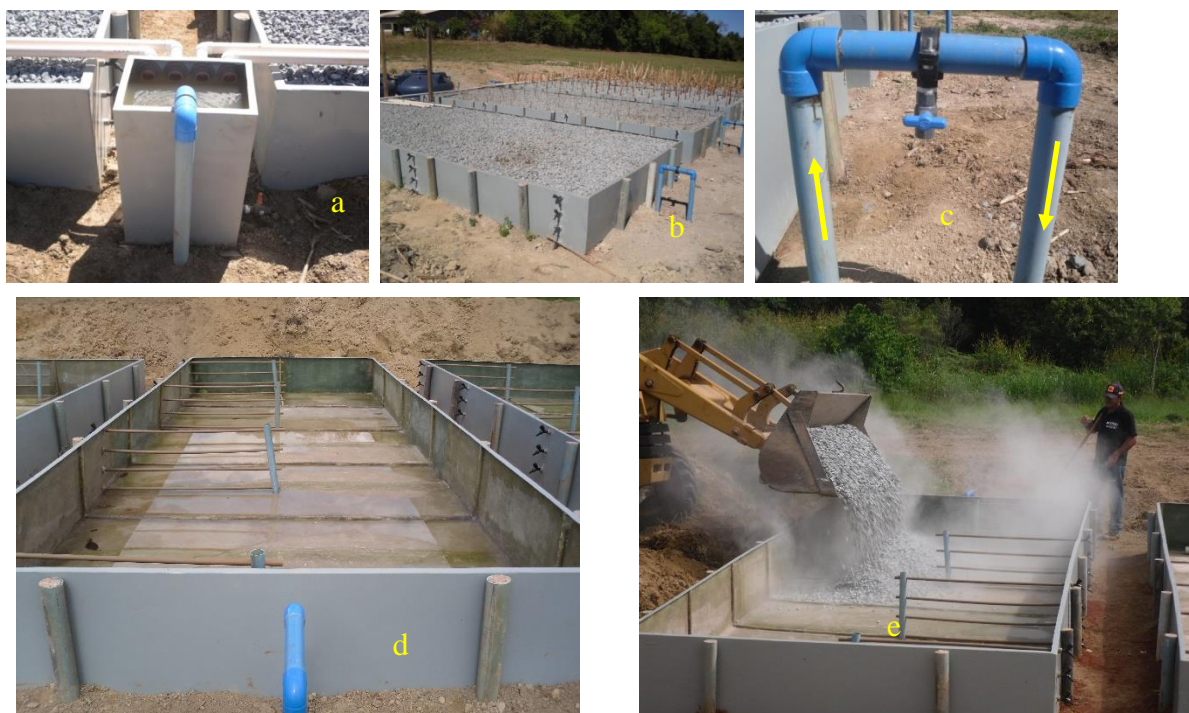
FIGURA 5. Caixa de passagem para os leitos cultivados (a), vista dos leitos cultivados e do não cultivado (b) e do cavalete de controle do nível do efluente no interior dos leitos (c), imagem interna do SZR (d) e colocação da brita no interior dos SZR (e).
