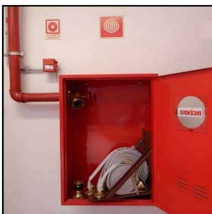
Figura 14: Abrigo do hidrante. Fonte: O autor.
