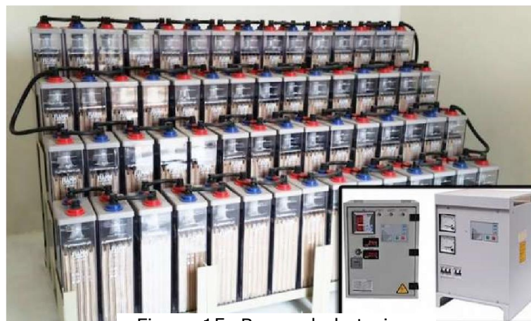
Figura 15: Banco de baterias.
