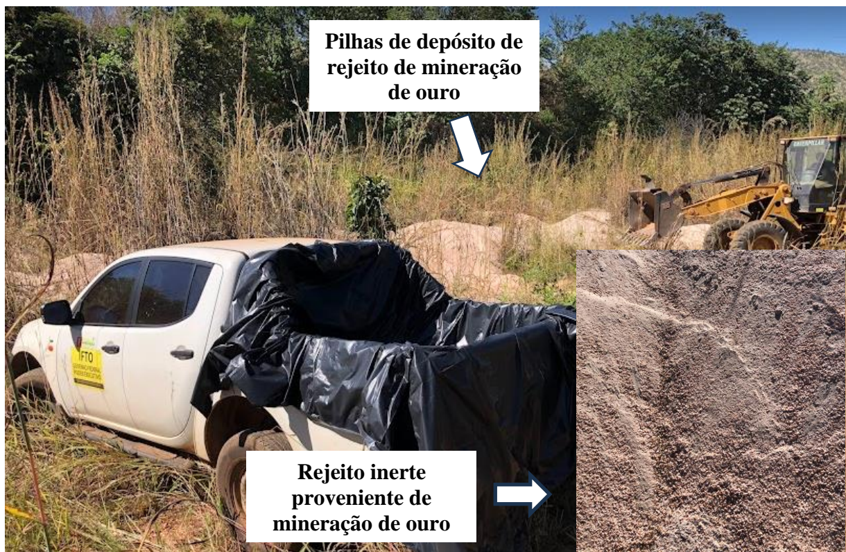
Figura 3.8. Coleta do rejeito em pilhas depositadas e transporte confinado em lona plástica.
