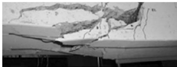
Ruptura por CCS induzida por fissura de flexão-cisalhamento
