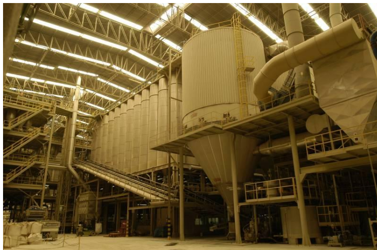
Figura 06: Torres de Refrigeração Fonte: Empresa de Cerâmica
