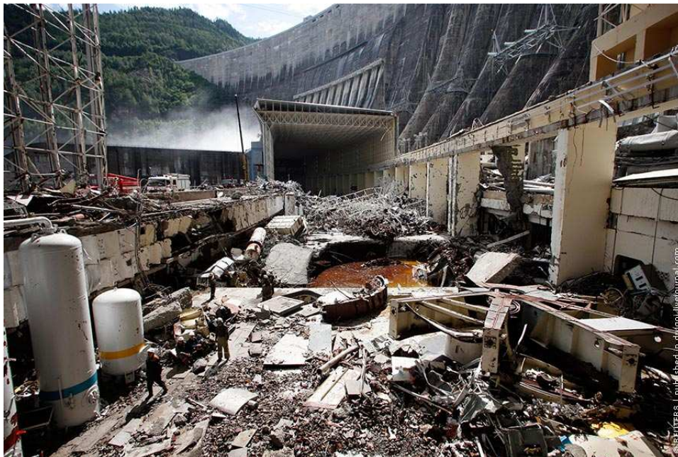
Figura 1.4: Transientes hidráulicos causam destruição na Usina Hidrelétrica de Sayano-Shushenskaya, Sibéria, Rússia 17/08/09. Fonte: Livejournal (2009)
