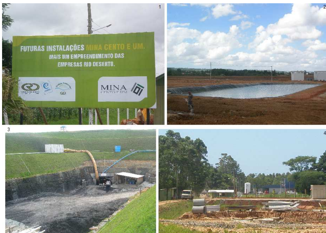
Figura 15: Fotos das instalações da Mina 101 (Foto 1: placa em frente à BR 101, entrada principal da mina; Foto 2 e 4: construção das Instalações da mina 101; Foto 3: modelo de entrada da mina a ser construído. Fonte: fotos do autor, 2009.
