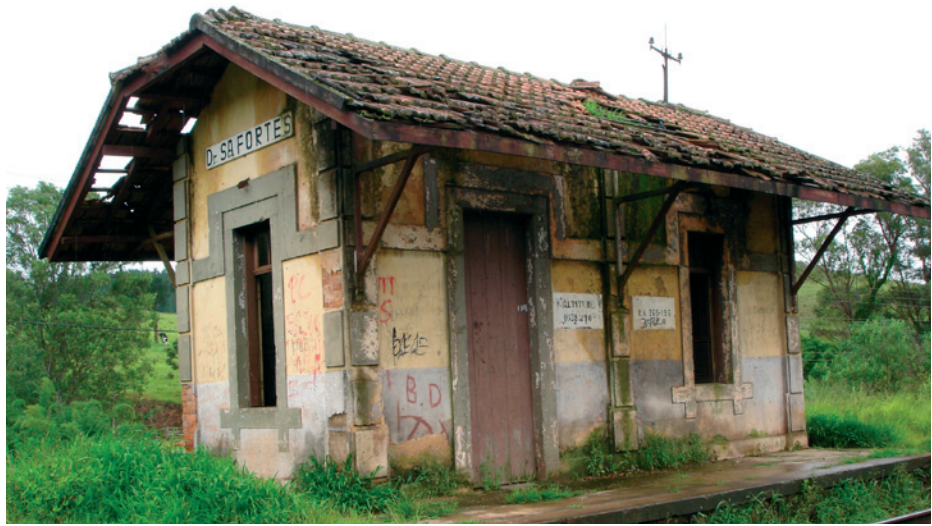
Figura 110: Vista da estação
