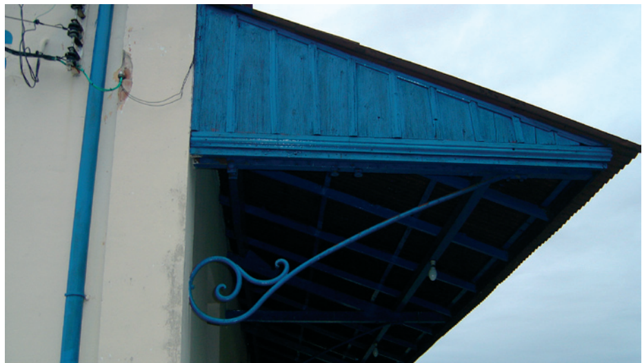
Figura 71: Vista da Estação.
