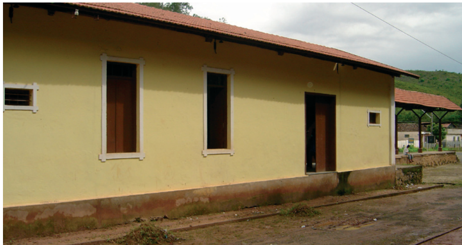
Figura 86: Vista da estação
