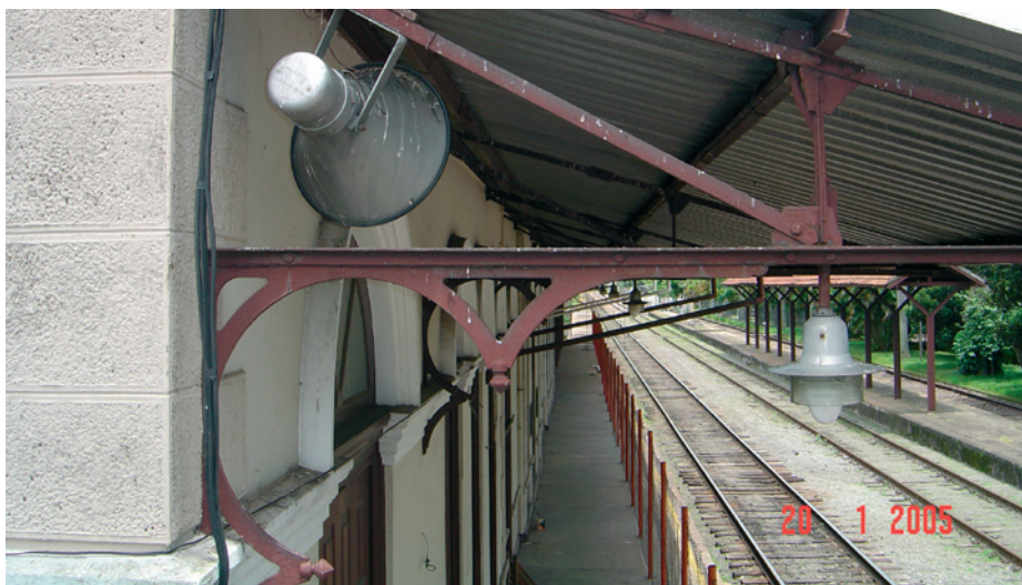
Figura 57: Vista da Estação.
