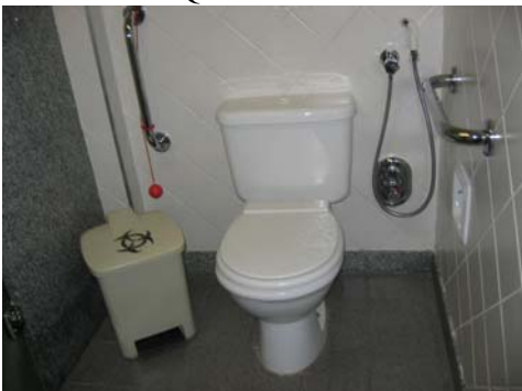
FIGURA 59 - EQUIPAMENTOS DO BANHEIRO
