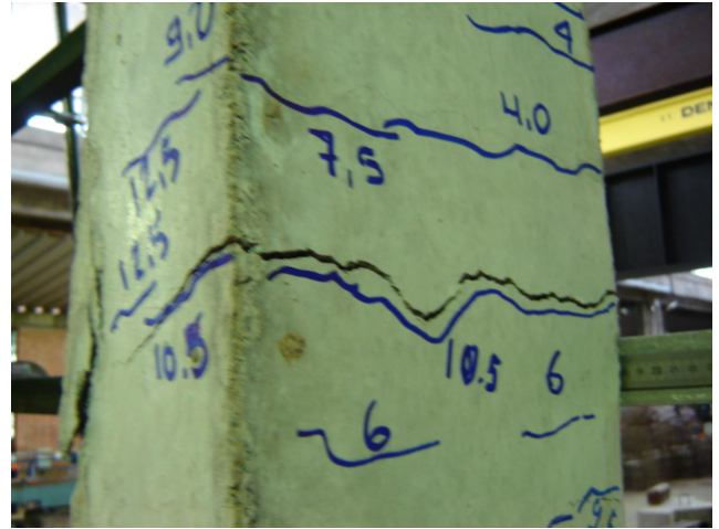
Figura 4.13 – Ruptura do pilar PFN60-3
