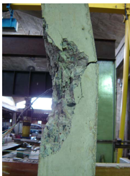
Figura 4.3 – Ruptura do pilar PFN0-3
