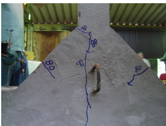
Figura 4.2 – Fissura no pilar PFN0-3
