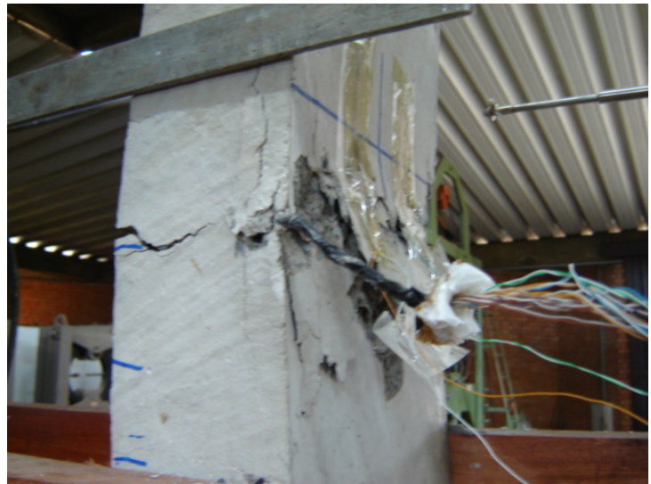
Figura 4.9 – Ruptura do pilar PFN40-3
