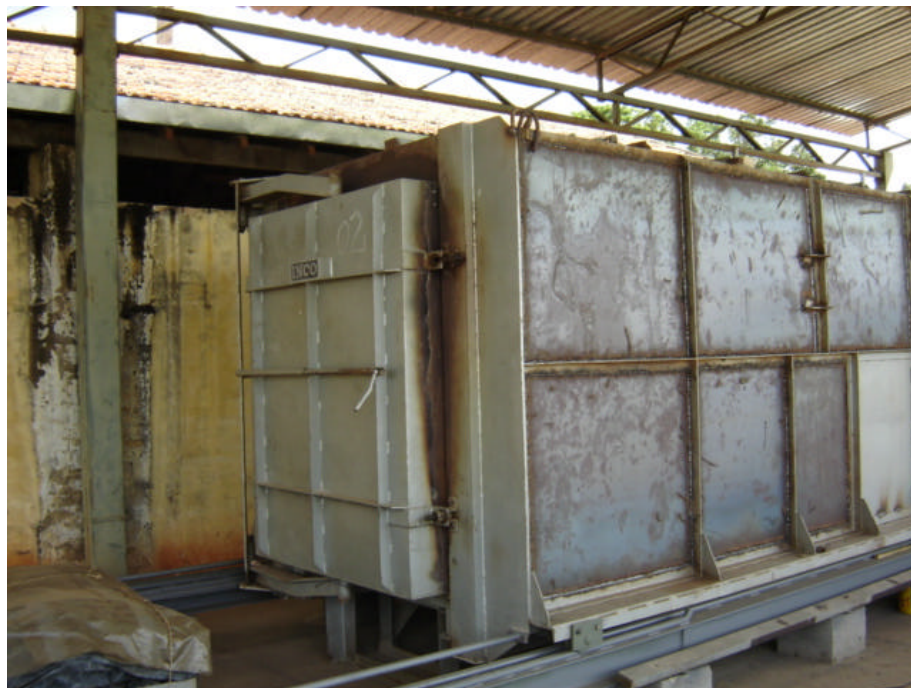
Figura 3.3.1: Forno a gás em fase de testes na Cerâmica Boa Nova
