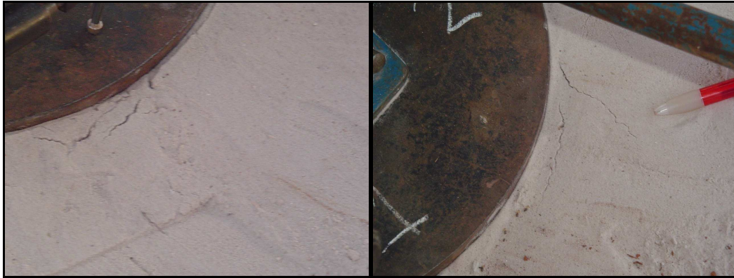
Figura 3.46 – Fissuras no solo ao redor da placa.
