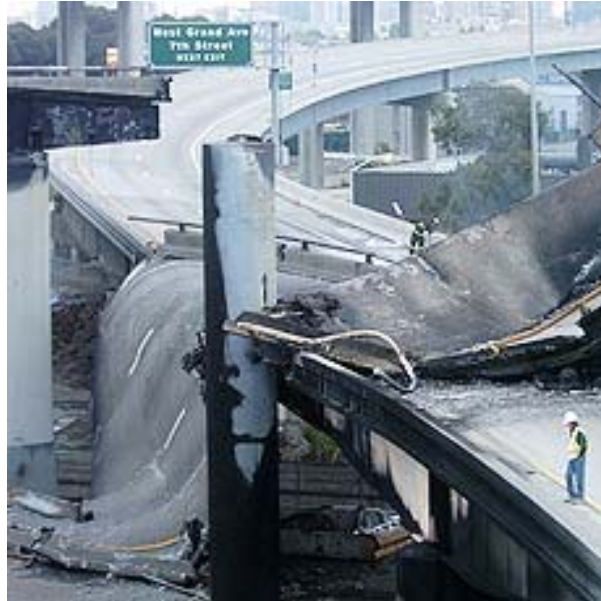
Figura 2.7: Acidente na ponte San Francisco - Oakland Bay, na Califórnia – EUA.
