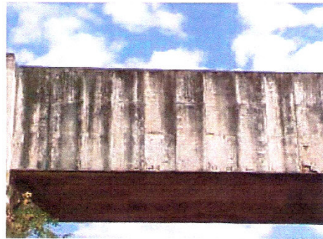
Fig. 4: Corrosão ( F_i=2 ); Deslocamento ( F_i=3 )
