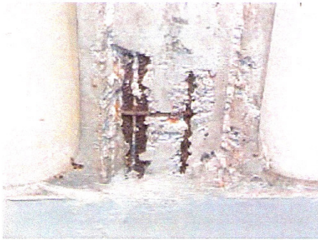
Fig. 1: Cobrimento deficiente ( F_i=3 )
