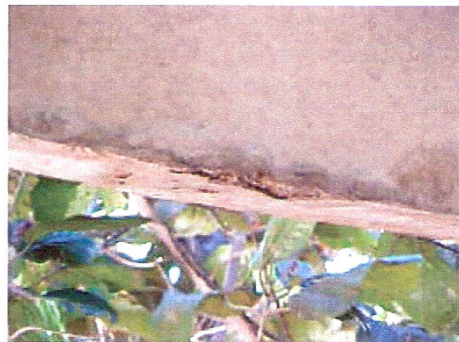
Fig. 5: Corrosão ( F_i=2 ); Deslocamento do concreto da viga) ( F_i=2 )
