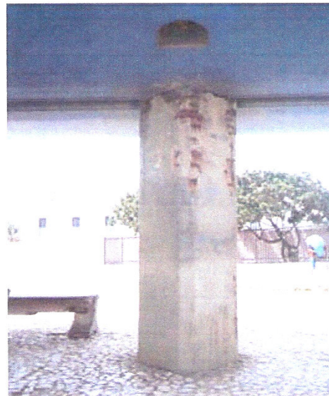
Fig. 10 - Corrosão na parte superior do pilar ( F_i=3 )
