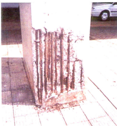
Fig. 9 - Corrosão ( F_i=4 ) Desplacamento ( F_i=4 )
