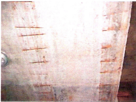
Fig. 2: Cobrimento deficiente ( F_i=2 )
