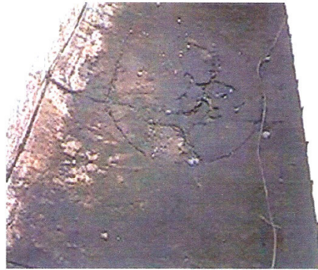
Fig. 27 - Impermeabilização degradada (calha em laje de cobertura) ( F_i=4 )
