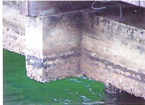
Fig. 15 - Desagregação do concreto ( F_i=3 )
