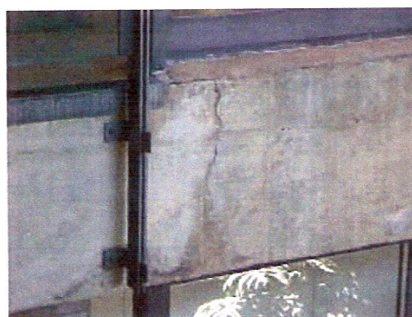
Fig. 22 - Fissura em viga (Fi=3)
