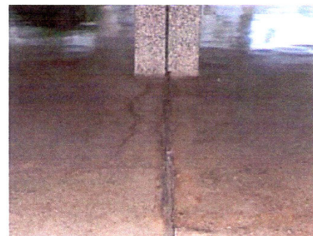
Fig. 35 - Obstrução de juntas de dilatação ( F_i=3 )
