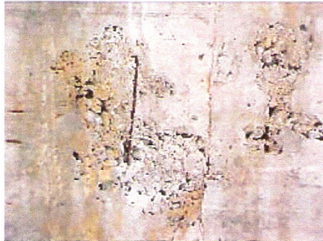
Fig. 36 – Falha de concretagem (Fi=2)
