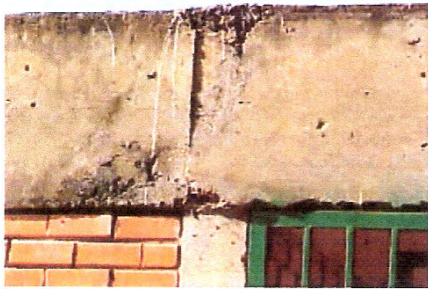
Fig. 37 – Falha de concretagem (Fi=2)
