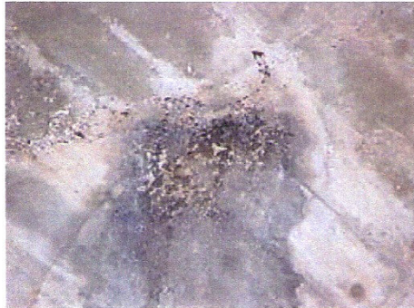
Fig. 30 - : Umidade ( F_i=3 )/ eflorescência ( F_i=3 )
