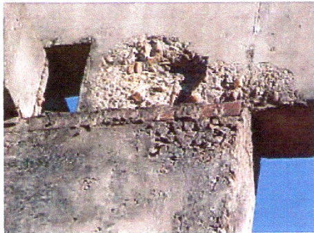
Fig. 12 - Desagregação do concreto na viga ( F_i=4 ) e Falha de concretagem no pilar ( F_i=1 )
