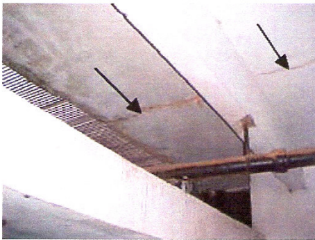
Fig. 25 - Fissura em laje ( F_i=3 )
