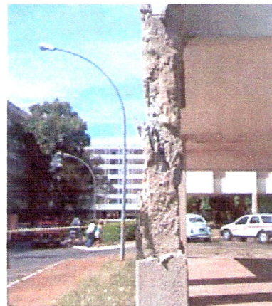
Fig. 40 – sinais de esmagamento do concreto em pilar com flambagem da armadura (Fi=4)
