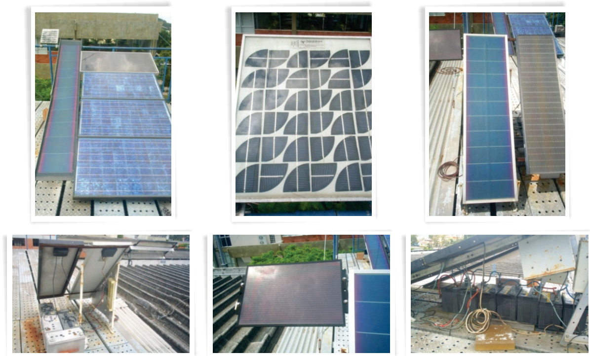
Figura 21 - EQUIPAMENTOS DISPOSTOS NA COBERTURA DO LABSOLAR. Acervo Particular
