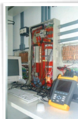
EQUIPAMENTOS DE MEDIÇÕES DE ENERGIA
