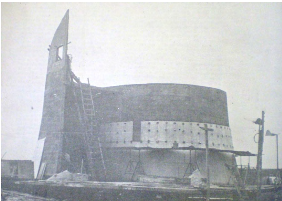
Figura 26 - Capela do Palácio da Alvorada, recebendo revestimento de mármore. Fonte: Brasília nº 16, abr. 1958. p. 2.
