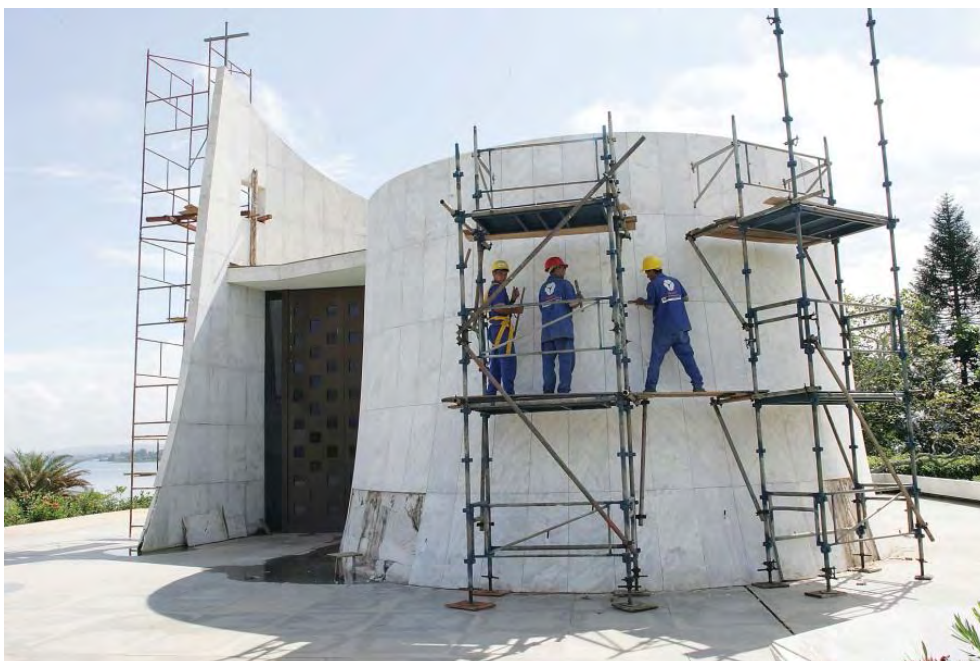
Figura 36 - Restauração da Capela do Palácio da Alvorada (Brasília, DF, 05/04/2006). Fonte: < http://www.imprensa.planalto.gov.br > Acesso em 27 abr. 2008.
