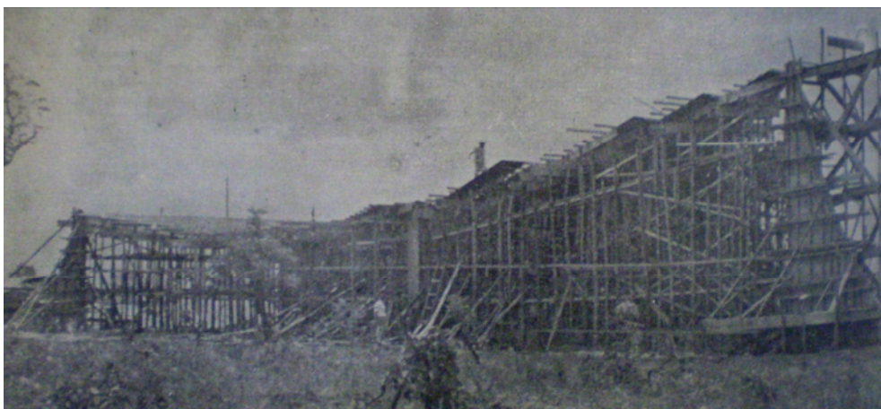
Figura 24 – Igreja Nossa Senhora de Fátima em construção. Fonte: Brasília nº 15, mar. 1958. p. 02.
