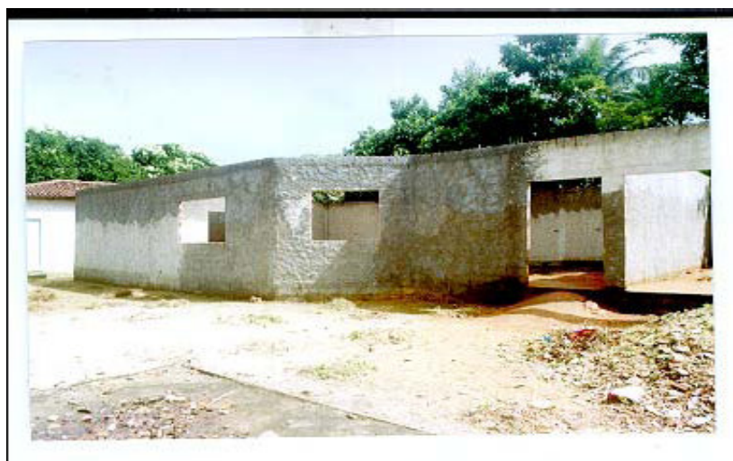
Figura 3 Obra não concluída em Itabela, Bahia
