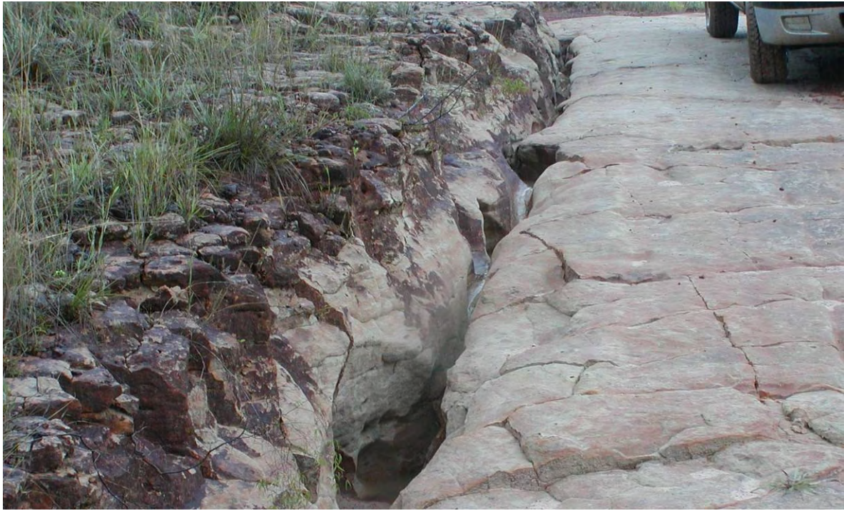
Figura E.7. Erosão concentrada em rocha arenítica medianamente alterada.
