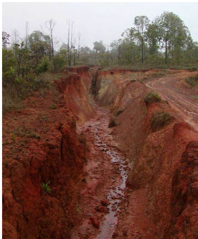
Figura E.2. Processo erosivo próximo à estrada rural, sem evidências de tratamento.
