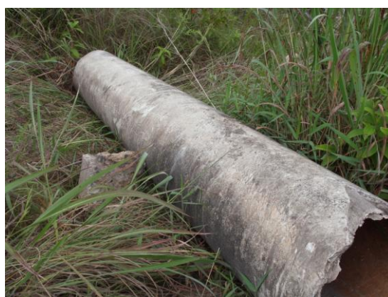
(b) Tubulação substituída, abandonada na reserva.
