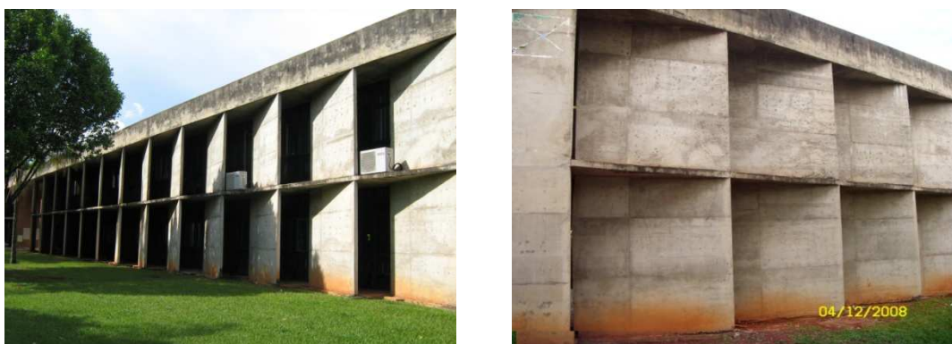
Figura 4.49 – Manchas nos detalhes arquitetônicos (Lessa e Nóbrega, 2009)
