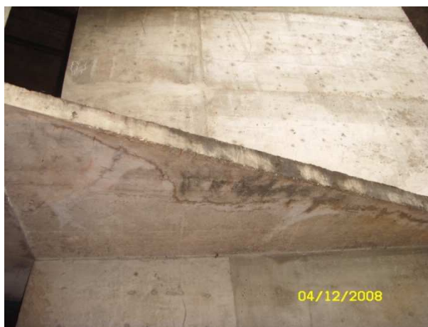
Figura 4.51 – Manchas na laje de avanço devido à falta de pingadeira (Lessa e Nóbrega, 2009)
