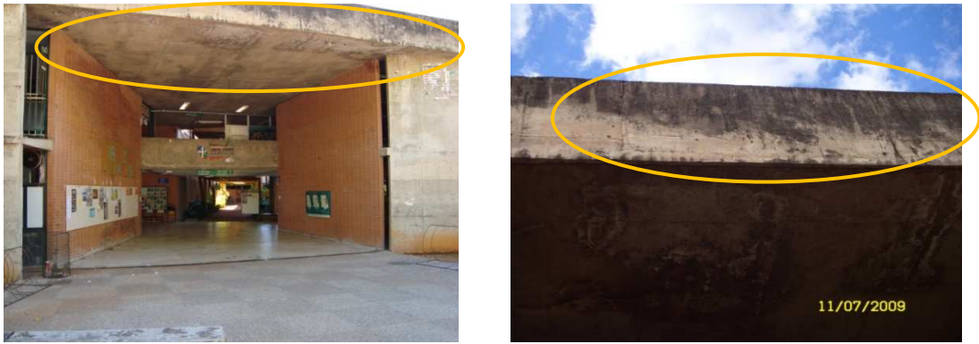
Figura 4.54 – Manchas e deterioração do concreto devido à ineficiência da pingadeira
