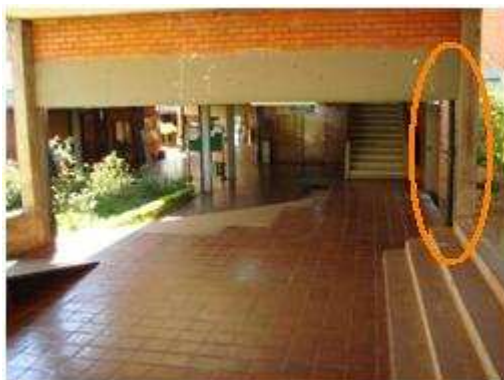
Figura 4.33 – Tubulação vertical passando no plano principal da viga
