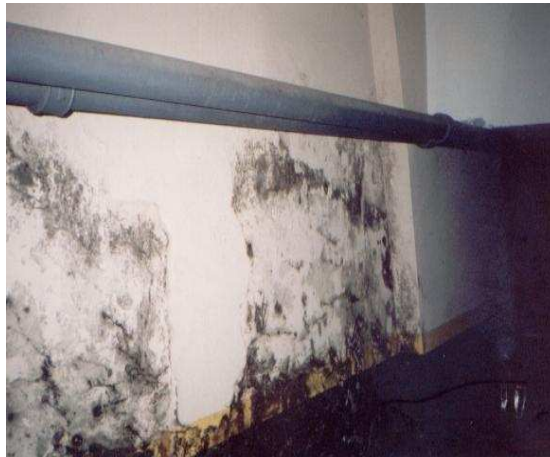
Figura 2.16 – Bolor em pavimento de garagem (Boldo, 2002)
