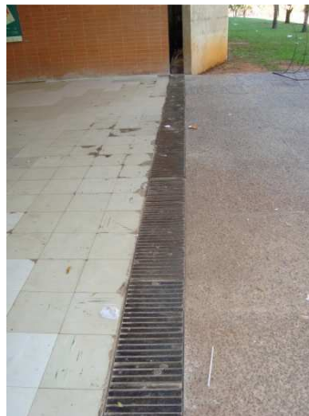
Figura 4.55 – Dispositivo de drenagem na entrada da FA
