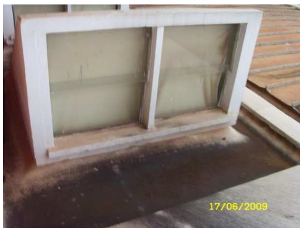
Figura 4.43 – Manchas devido à acumulação de água
