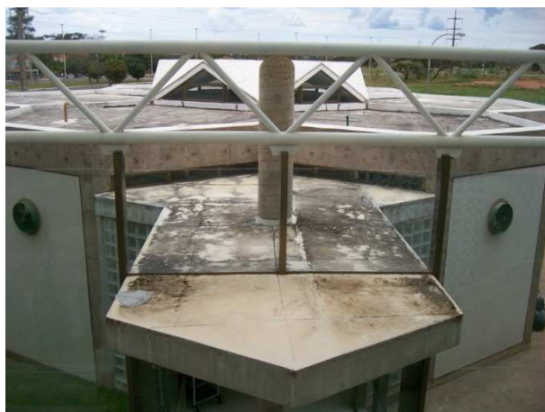
Figura 4.15 – Manchas na cobertura do Almojarifado do IQ
