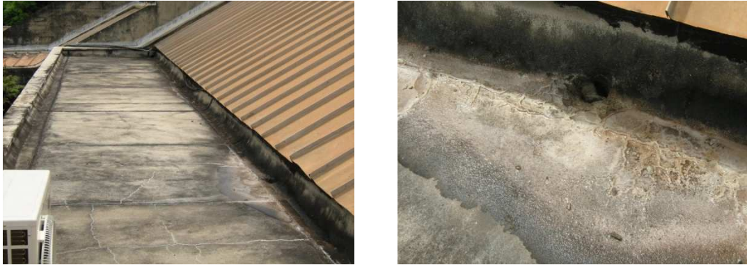
Figura 3.2 – Acumulação de água sobre a laje de concreto armado do prédio da FT
