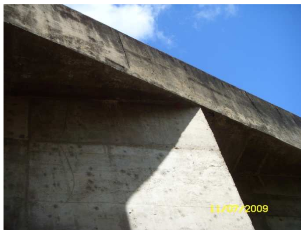
Figura 4.50 – Ausência de pingadeira na viga superior (Lessa e Nóbrega, 2009)
