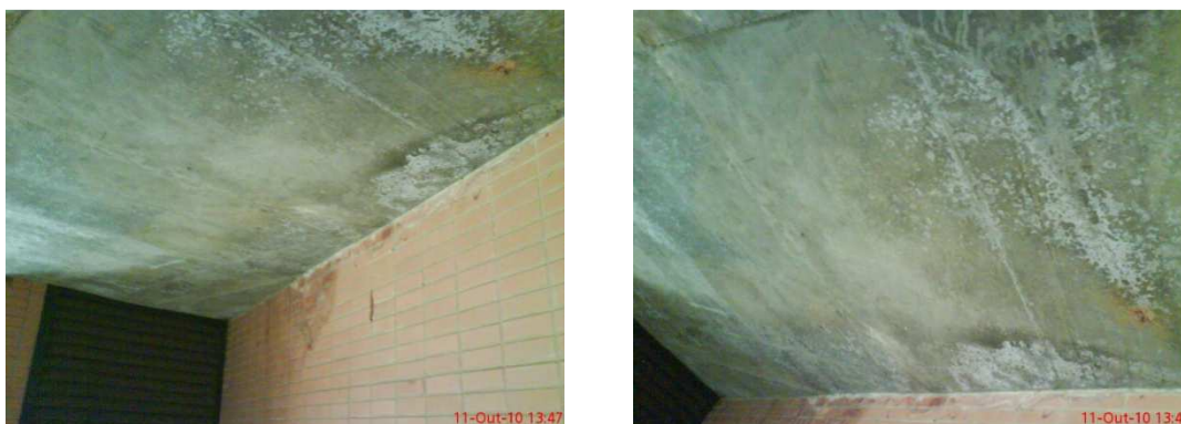
Figura 5.1 – Manchas no interior do prédio ocasionada por infiltração nos sheds
