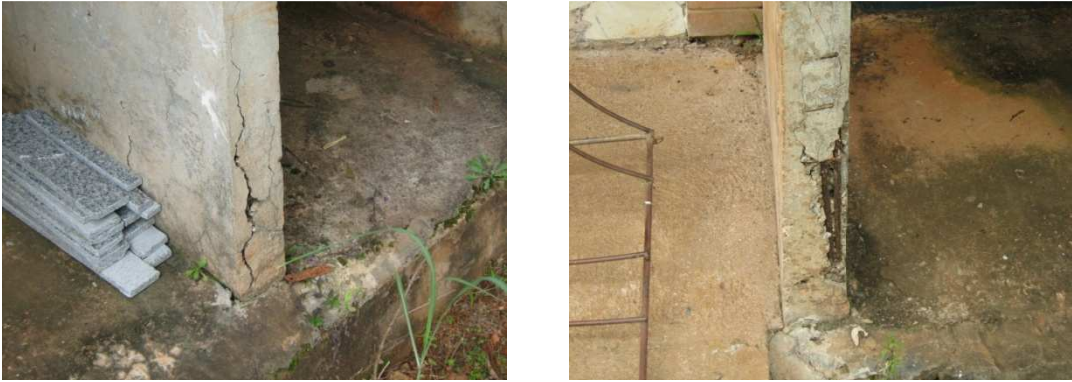
Figura 4.52 – Trincas e deterioração total do concreto
