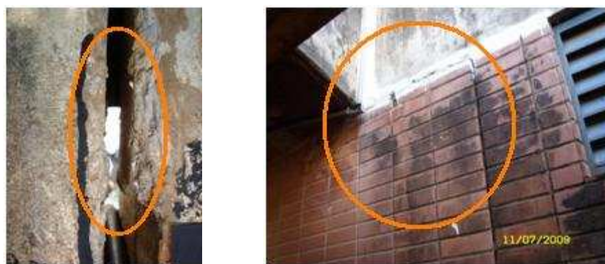
Figura 3.6 – Junta de dilatação deteriorada (Lessa e Nóbrega, 2009)
