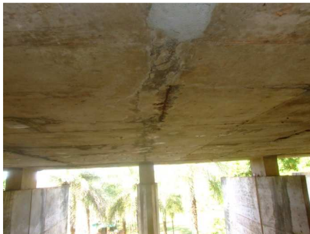
Figura 2.10 – Corrosão de armadura (Gratão, 2008)
