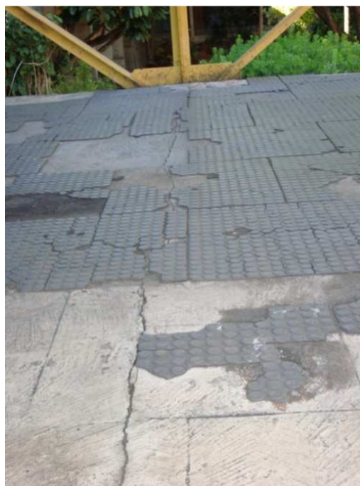
Figura 4.65 – Trincas localizadas na laje de piso da passarela
