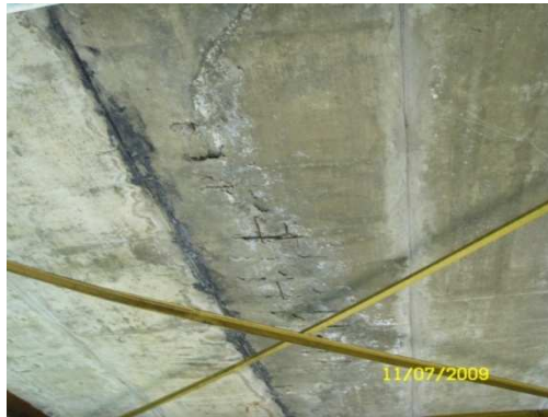
Figura 4.64 – Concreto da laje de piso com armadura exposta
