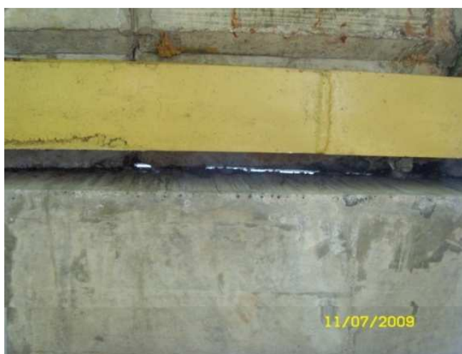
Figura 4.67 – Aberturas na junta favorecendo a passagem de água (vista pela parte inferior)
