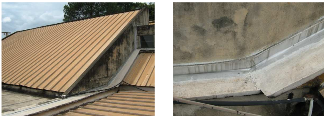
Figura 3.8 – Detalhe do rufo localizado na cobertura do prédio da FT, evitando a penetração de umidade na parede do prédio
