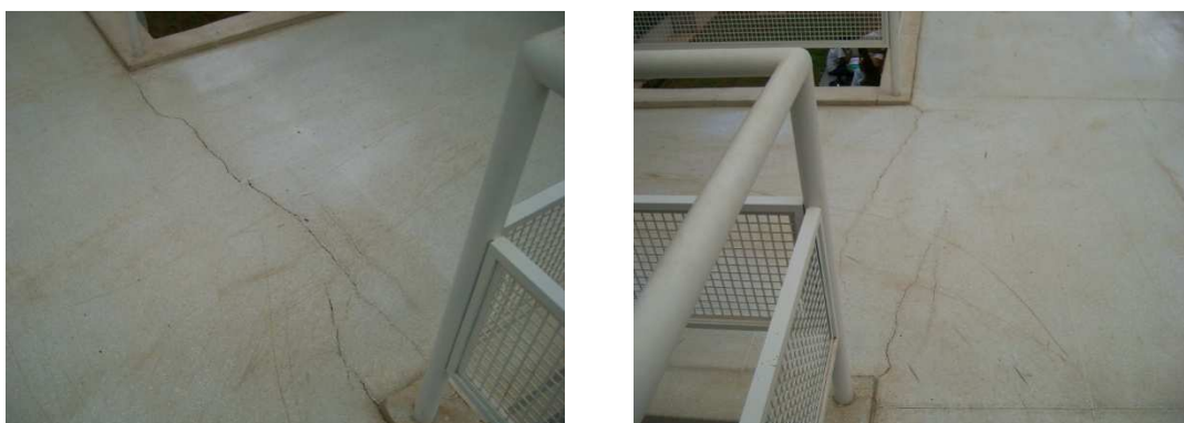
Figura 4.19 – Fissuras na região dos encontros da passarela com a estrutura do prédio
