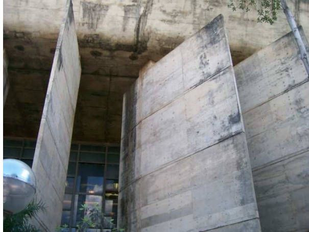
Figura 3.13 - Brises de concreto do prédio da Biblioteca Central da UnB com a presença de manchas devido à umidade.
