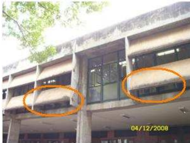
Figura 4.56 – Presença de manchas nos brises de concreto
