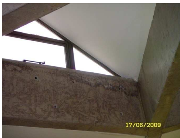
Figura 4.14 – Manchas localizadas em vigas localizadas no almojarifado do IQ
