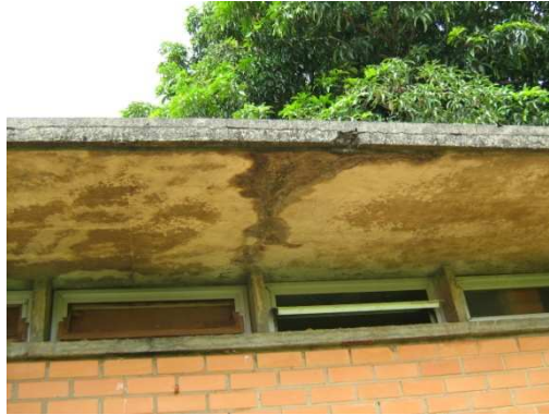
Figura 3.10 – Marquise do prédio da FT/UnB com manchas de umidade
