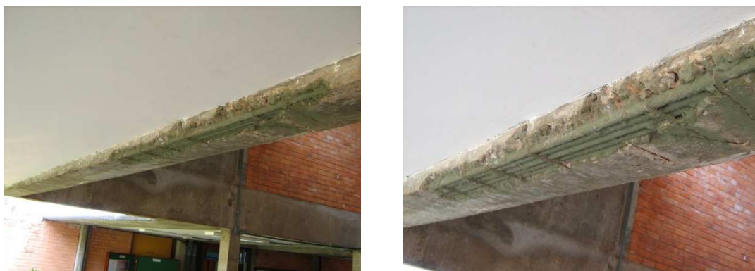
Figura 4.39 – Viga apresentando destacamento do concreto e armadura exposta
