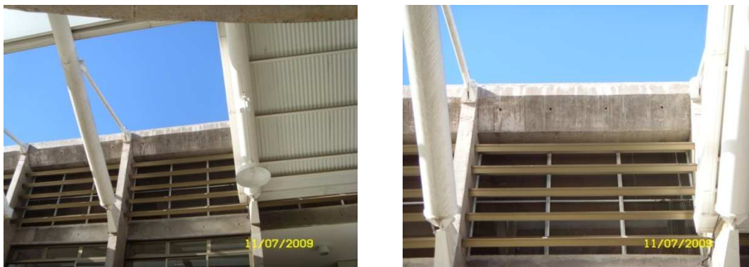
Figura 4.13 – Manchas esbranquiçadas de lixiviação no interior do IQ
