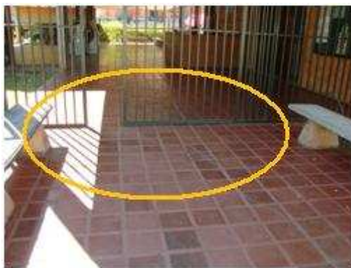
Figura 4.32 – Entrada do FT desprovida de sistema de drenagem
