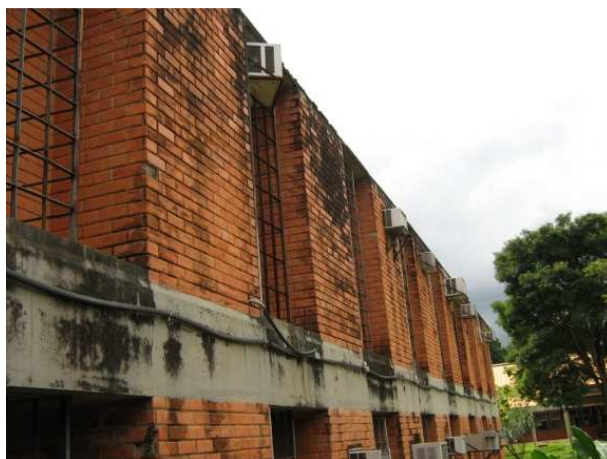
Figura 4.38 – Manchas de umidade em janelas e na alvenaria
