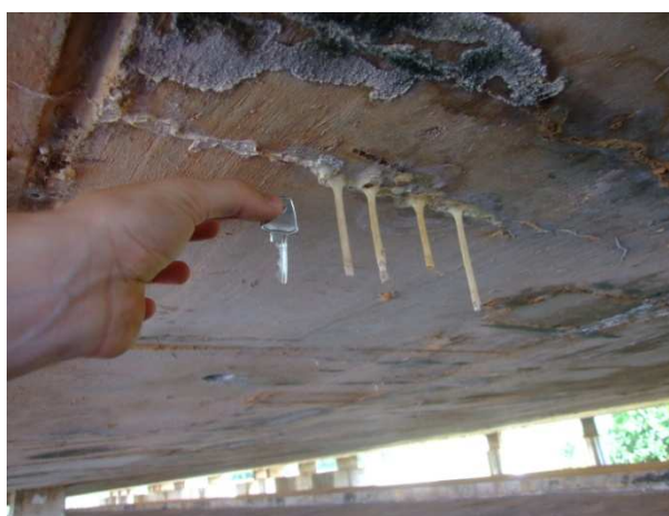
Figura 2.13 – Eflorescências em encontro de vigas em pavimento de garagem (Gratão, 2008)
