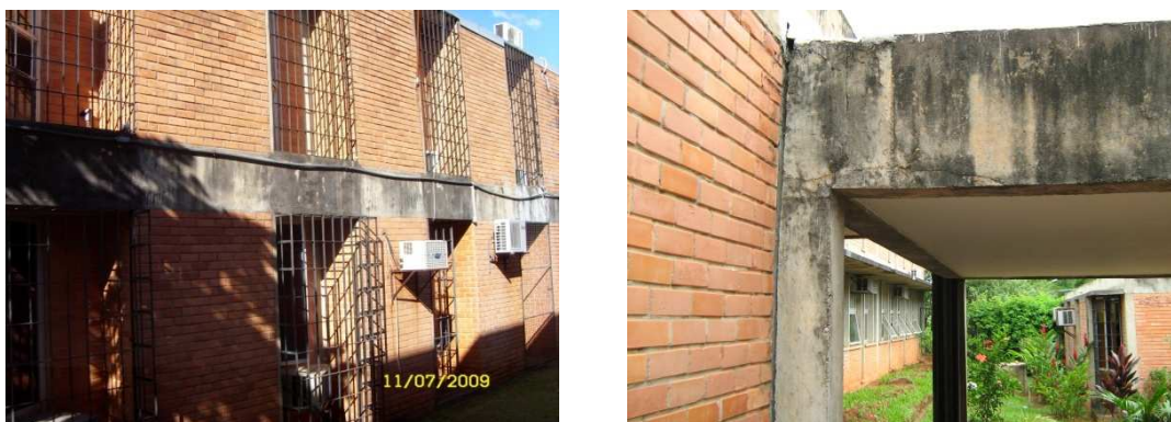
Figura 4.37 – Vigas apresentando manchas e deterioração do concreto
