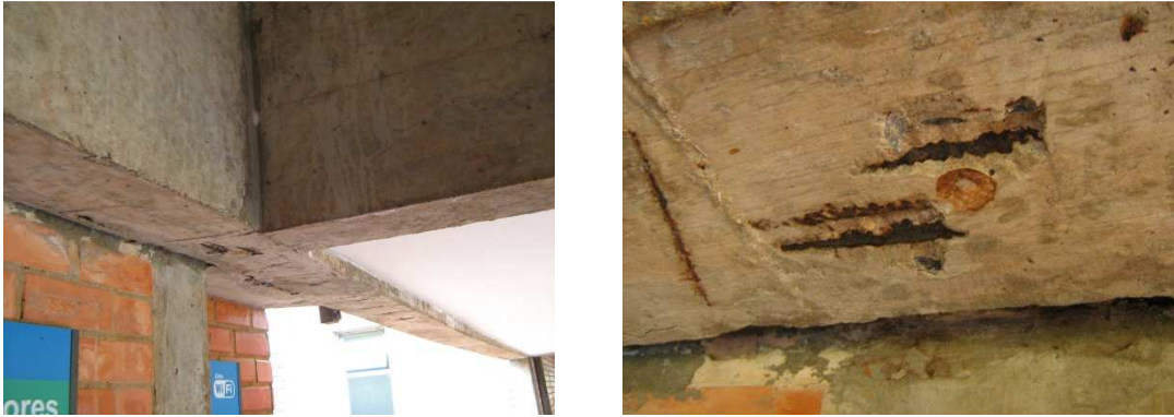
Figura 4.40 – Corrosão de armadura de viga
