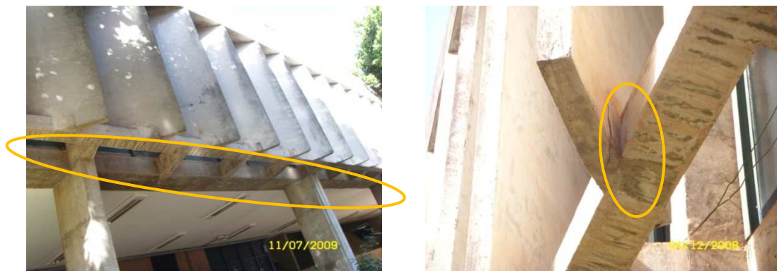
Figura 4.58 – Trincas no encontro dos elementos
