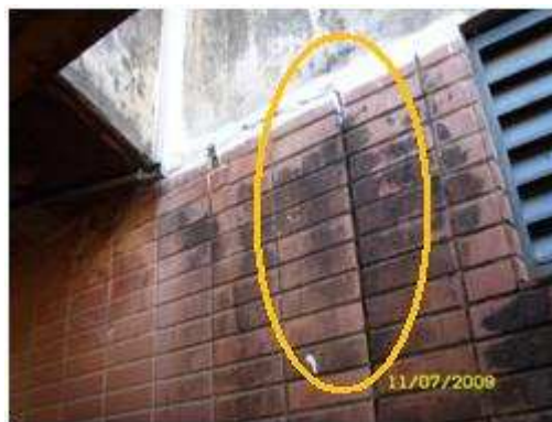
Figura 4.74 – Trincas na alvenaria ocasionadas pela movimentação da estrutura
