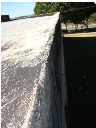
Figura 3.7 – Platibanda do prédio da FA deteriorada e com manchas de umidade (Lessa e Nóbrega, 2009)
