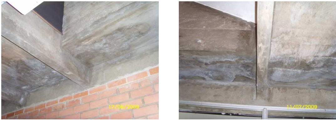
Figura 4.44 – Manchas no interior da edificação
