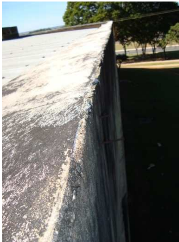
Figura 4.72 – Platibanda com manchas
