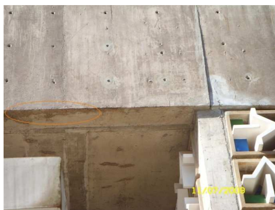
Figura 4.12 – Manchas na fachada frontal do IQ devido à falta de pingadeira
