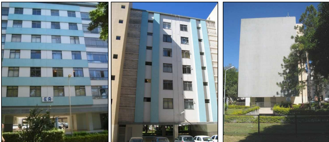
Figura 4.11 – Fotos da junta estrutural existente entre blocos (esquerda), detalhe do pano de elementos vazados (centro) e empena (direita) do edifício B.
