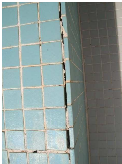
Figura 2.31 – Falha de rejunte (LEM- UnB, arquivo fotográfico).
