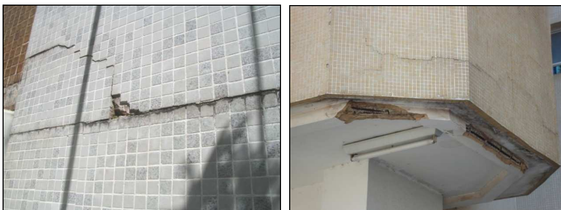
Figura 2.23 – Detalhes de fissuração (LEM-UnB, arquivo fotográfico).
