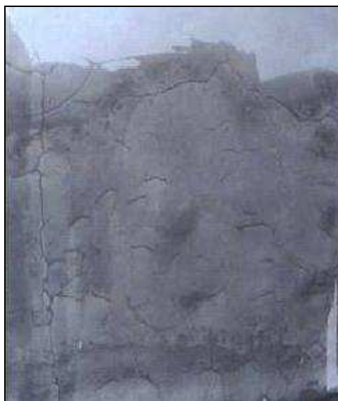
Figura 2.17 – Detalhe de sarrafeamento precoce (LEM- UnB, arquivo fotográfico).
