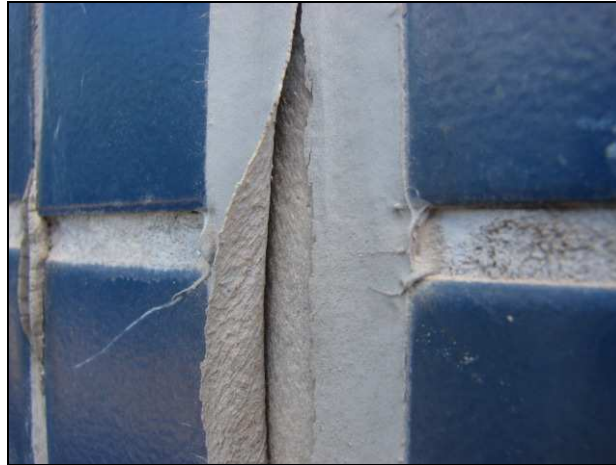
Figura 2.33 – Junta de movimentação deteriorada, cujo selante foi empregado numa camada excessivamente fina (LEM- UnB, arquivo fotográfico).
