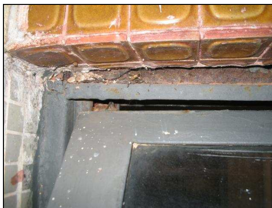
Figura 2.45 – Detalhe de falha de vedação (LEM- UnB, arquivo fotográfico).
