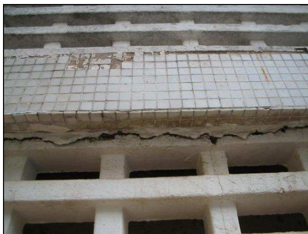
Figura 5.11 – Falha de rejunte no encontro com os elementos vazados.
