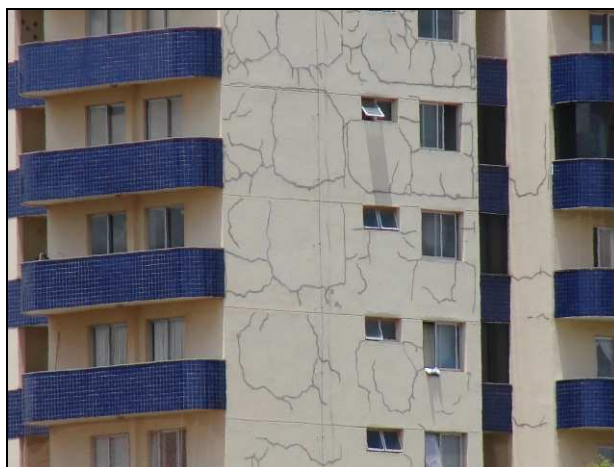
Figura 2.27 - Detalhes de fissuras mapeadas (LEM- UnB, arquivo fotográfico).
