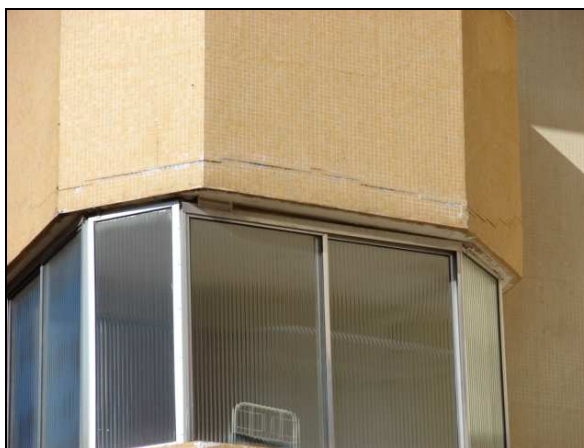
Figura 2.25 – Fissura acompanhando o sentido da viga.
