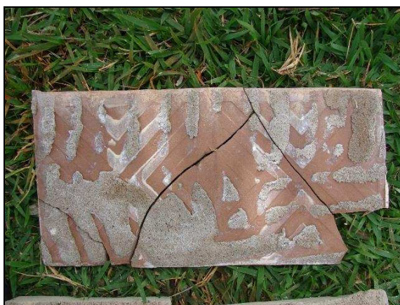
Figura 5.6 – Falhas de espalhamento do filete de argamassa no tardo da cerâmica.
