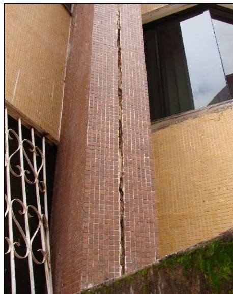
Figura 2.34 – Detalhe de falha na junta estrutural (LEM- UnB, arquivo fotográfico).
