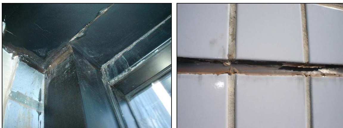
Figura 5.29 – Falha de vedação no encontro da esquadria com a cerâmica cinza-clara (esquerda) e junta de movimentação deteriorada (direita).
