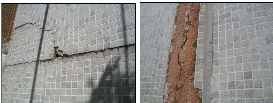
Figura 5.17 – Transição entre pavimentos com fissuração (esquerda) e junta estrutural com deslocamento e deterioração do emboço com uso de saibro (direita).
