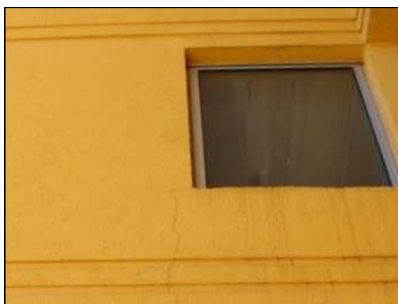
Figura 2.24 – Fissura de canto em abertura.
