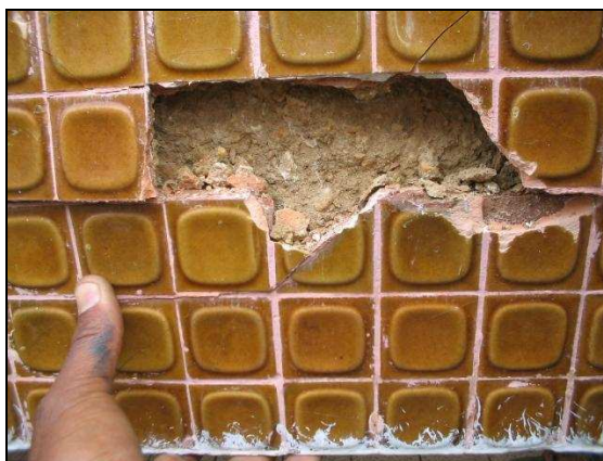
Figura 2.43 – Detalhe de placa cerâmica rompida (LEM- UnB, arquivo fotográfico).
