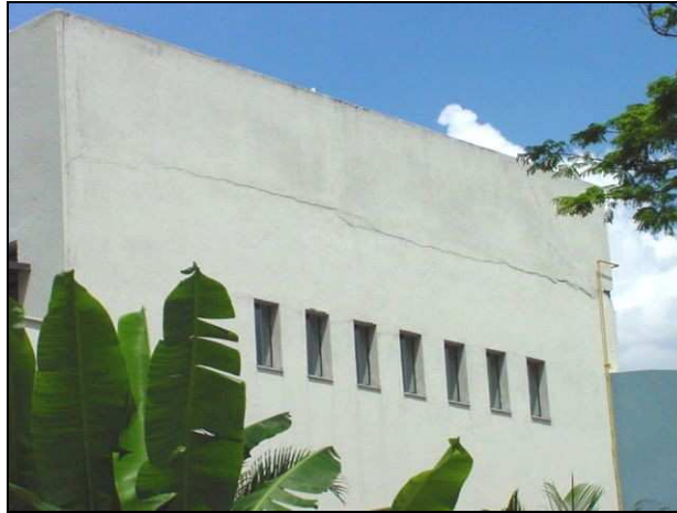
Figura 2.26 - Detalhe de fissura de topo.
