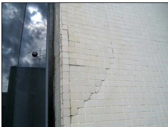
Figura 2.19 - Descolamento localizado do revestimento cerâmico (LEM- UnB, arquivo fotográfico).
