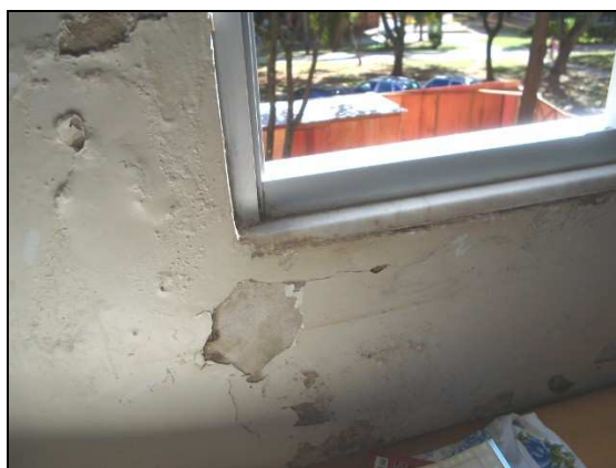
Figura 2.48 – Visão interna de empolamento da pintura gerada pela infiltração de umidade (LEM- UnB, arquivo fotográfico).
