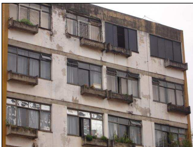
Figura 2.35 – Bolor sobre a fachada de um edifício.
