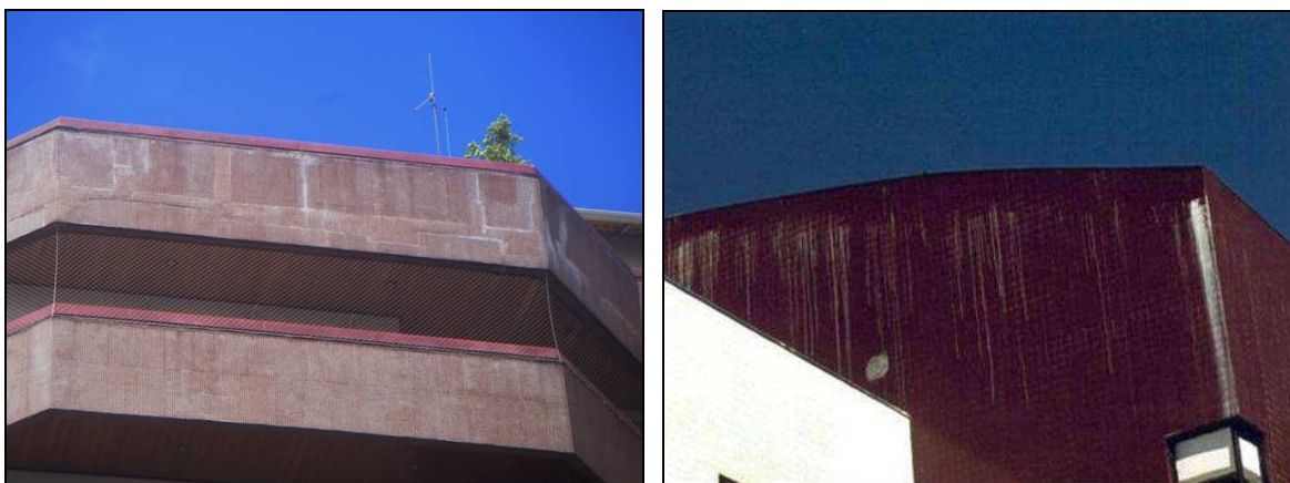
Figura 2.36 – Detalhes de eflorescência (LEM- UnB, arquivo fotográfico).
