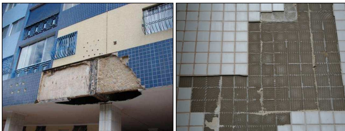
Figura 2.22 - Deslocamento localizado do emboço (esquerda) e de peças cerâmicas (direita) (LEM- UnB, arquivo fotográfico).
