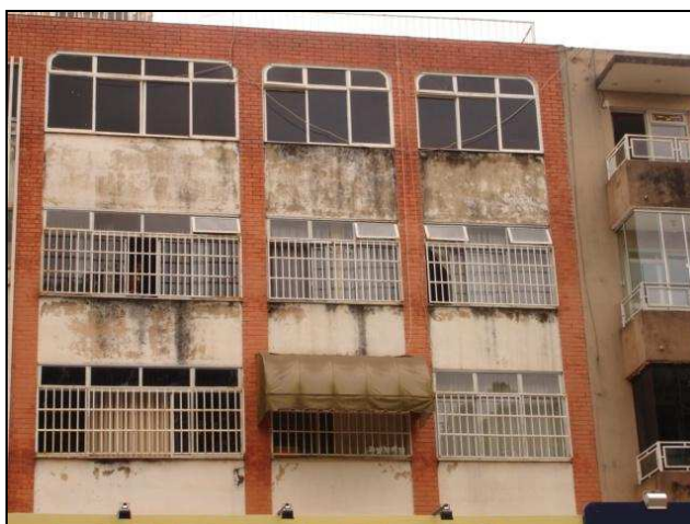
Figura 2.18 – Manchas de bolor ou mofo na fachada.
