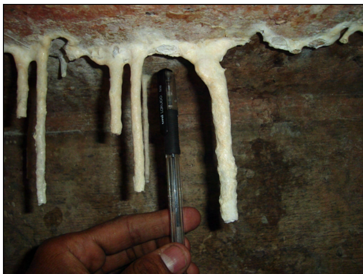
Figura 5.44 – Estalactites bem desenvolvidas na região da junta entre a longarina e a laje superior (galeria GA 30)
