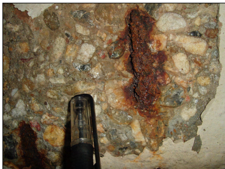
Figura 5.51b – Desagregação do concreto com exposição de armadura em processo de corrosão – visão aproximada (galeria GA 14)
