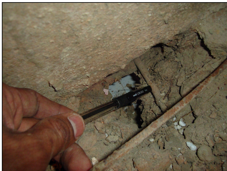
Figura 5.5 – Abertura na laje inferior da galeria posicionada sobre o Mezanino feita por usuários da Estação, deixando sua armadura passiva exposta (galeria GB 77)
