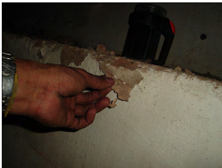
Figura 5.48 – Tinta descolando da superfície devido ao excesso de umidade (galeria GA 26)
