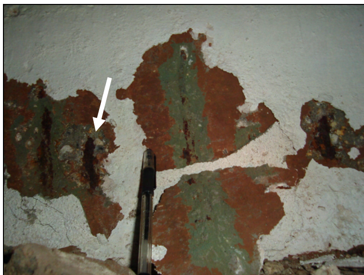
Figura 5.47 – Desagregação do concreto com exposição de armaduras (galeria GA 38)
