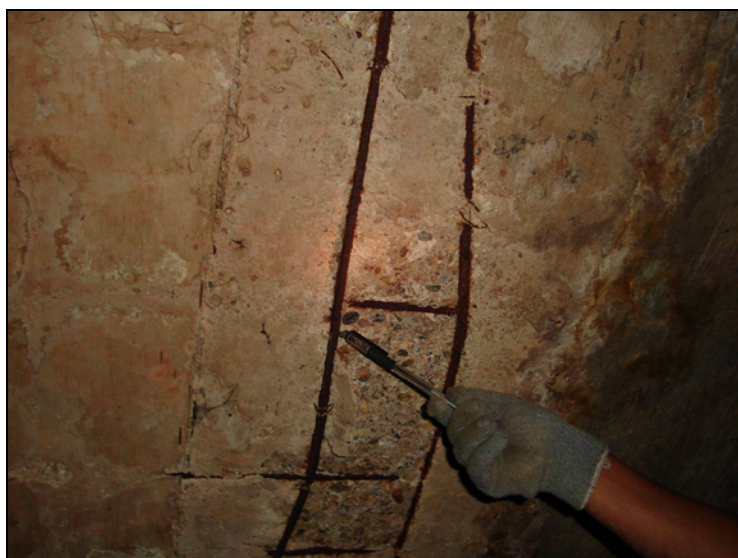
Figura 5.59 – Armaduras da laje superior expostas e corroídas (galeria GA 60)
