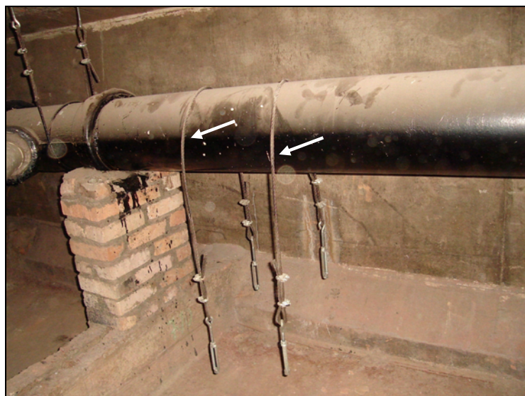
Figura 5.6 – Cabos de sustentação das tubulações de águas pluviais desativados (galeria GB 77)
