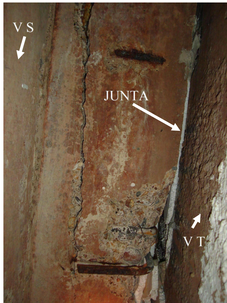
Figura 5.53 – Concreto fissurado e armaduras extremas laje superior expostas , próximo à junta de dilatação, em processo de corrosão (galeria GA 14)
