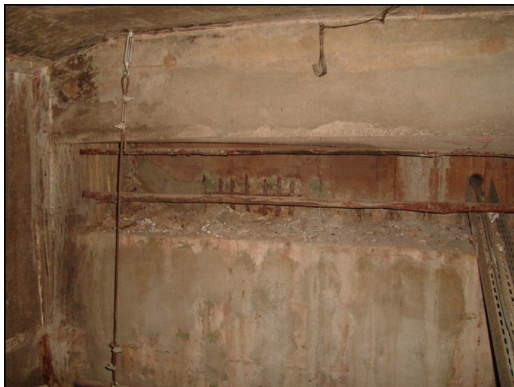
Figura 5.23 – Visão geral da VT 05 com suas armaduras expostas e em processo de corrosão (galeria GB 51)
