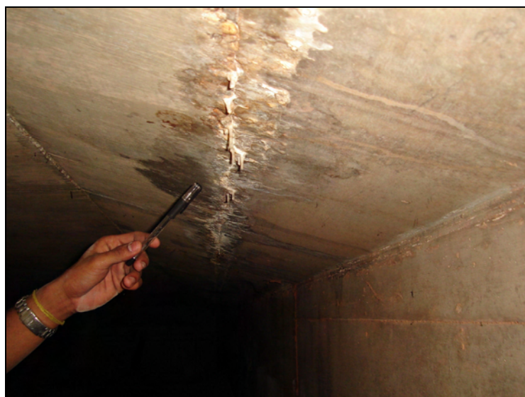
Figura 5.17 – Eflorescência com formação de estalactites entre a longarina e a laje superior da galeria (galeria GB 62)
