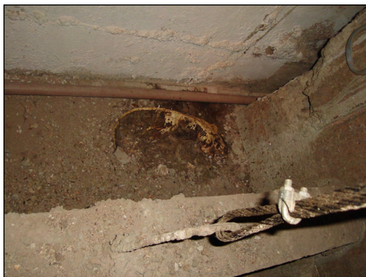
Figura 5.14a – Presença de restos de animal morto (galeria GB 74)
