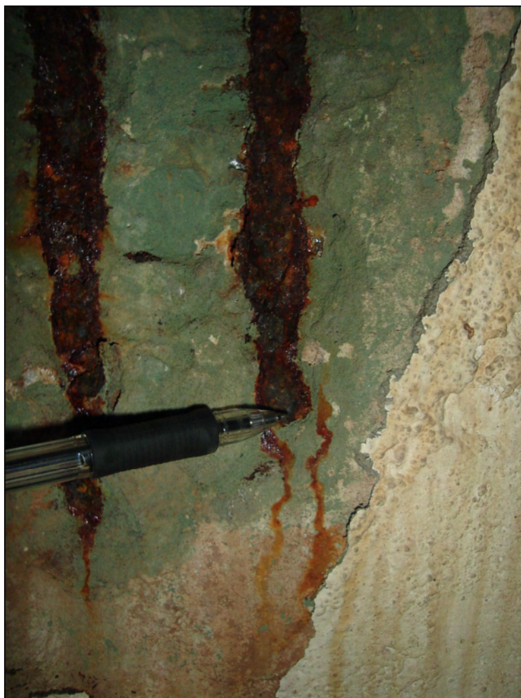
Figura 5.65d – Armaduras corroídas com sinais de infiltração em suas superfícies (galeria GA 57)
