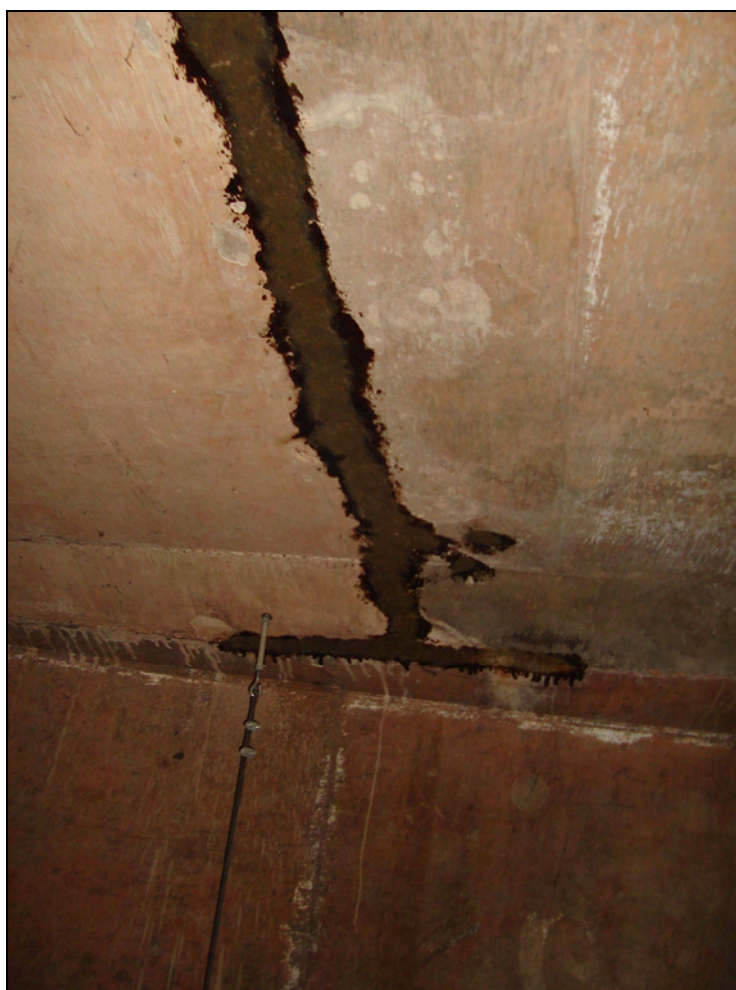
Figura 5.13 – Reparos antigos em boas condições (galeria GB 85)
