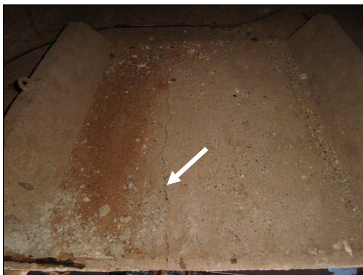
Figura 5.31 – Tampa de inspeção fissurada (galeria GB 39)
