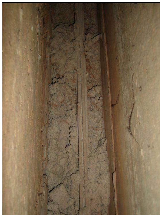
Figura 5.9 – Cabos de protensão expostos dentro das canaletas das lajes inferiores devido ao mau lançamento da argamassa protetora (galeria GB 86).
