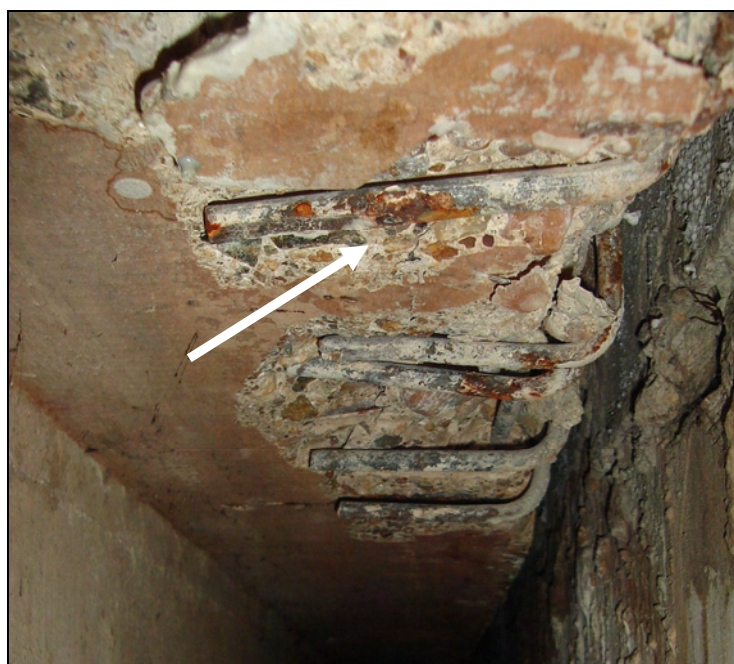
Figura 5.45 – Armaduras na extremidade da laje superior expostas (galeria GA 30)
