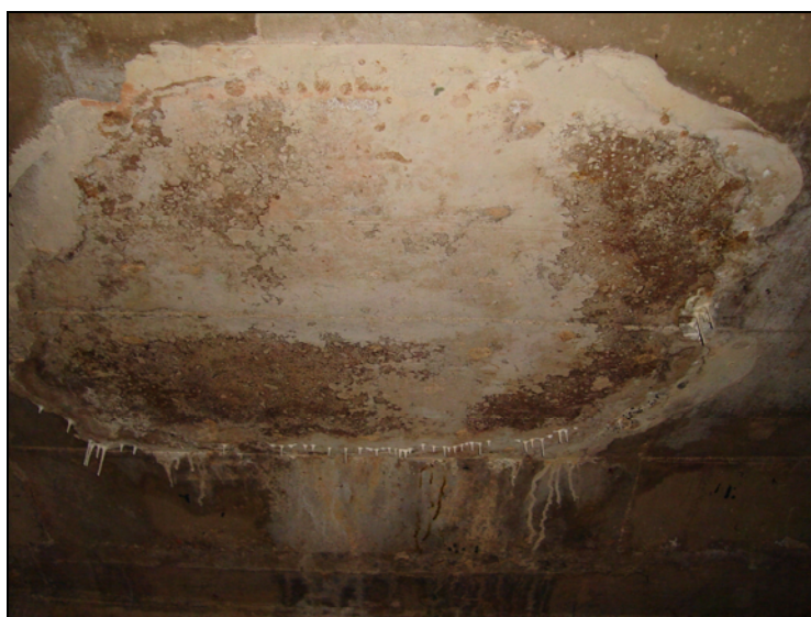
Figura 5.36 – Eflorescência e estalactites nas juntas de encontro entre o concreto novo do reparo e o antigo da laje superior (galeria GB 29)
