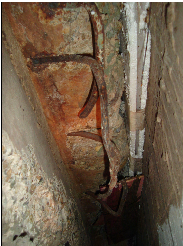
Figura 5.54 – Armaduras extremas da laje superior expostas e sem funcionalidade (galeria GA 13)
