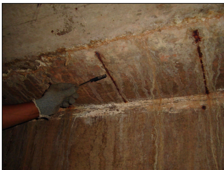
Figura 5.57 – Estribos da longarina em processo de corrosão (galeria GA 63)
