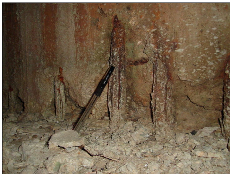
Figura 5.24 – Visão mais aproximada das armaduras em processo de corrosão (galeria GB 51)
