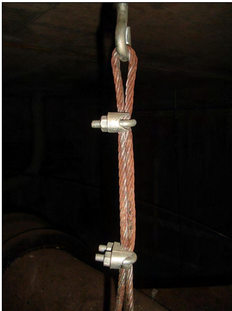
Figura 5.19 – Cabo de sustentação com leves inícios de corrosão (galeria GB 61)
