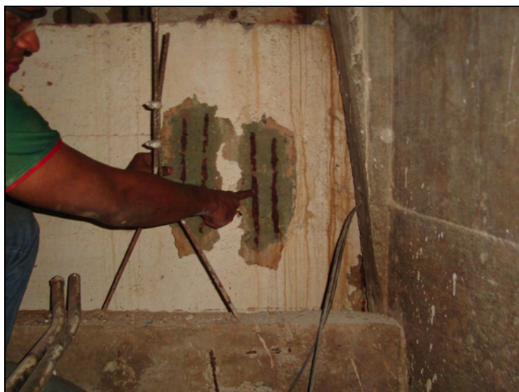
Figura 5.65b – Localização da desagregação do concreto – visão ampla (galeria GA 57)
