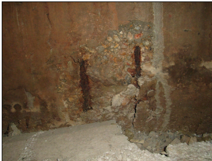
Figura 5.33 – corrosão da armadura com deslocamento do concreto da VT (galeria GB 41)
