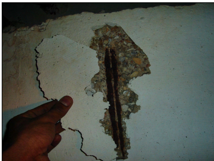
Figura 5.43b – Concreto superficial da VT desagregado e sua armadura exposta – visão aproximada (galeria GA 41)
