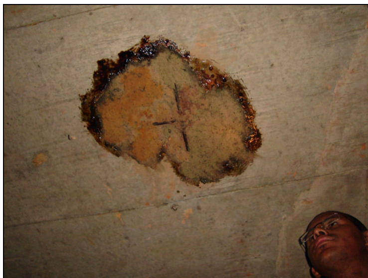
Figura 5.40 – Reparo antigo à base de resina epóxi sob a laje superior em bom estado, porém com leve exposição de armaduras (galeria GA 47)
