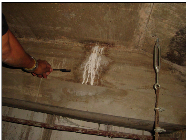
Figura 5.22 – Eflorescência na parte superior da VS, próximo à junta com a laje superior (galeria GB 51)
