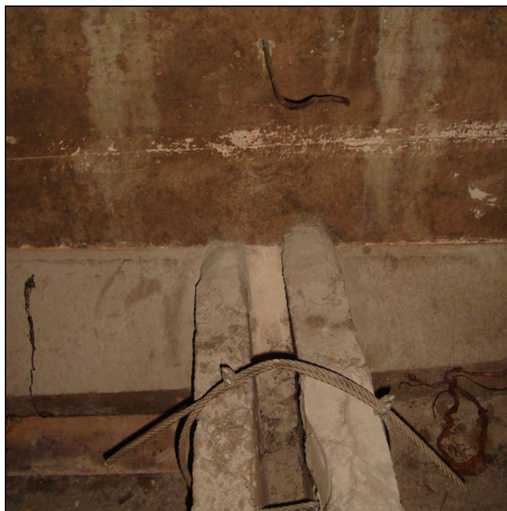
Figura 5.46 – Tirantes auxiliares de sustentação desativados (galeria GA 27)
