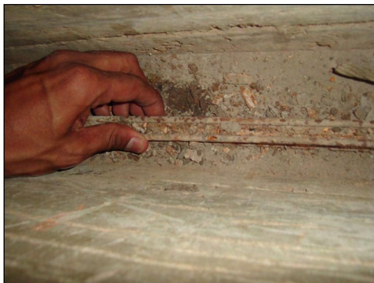
Figura 5.16 – Cabos de protensão expostos com leves sinais de corrosão (galeria GB 65)
