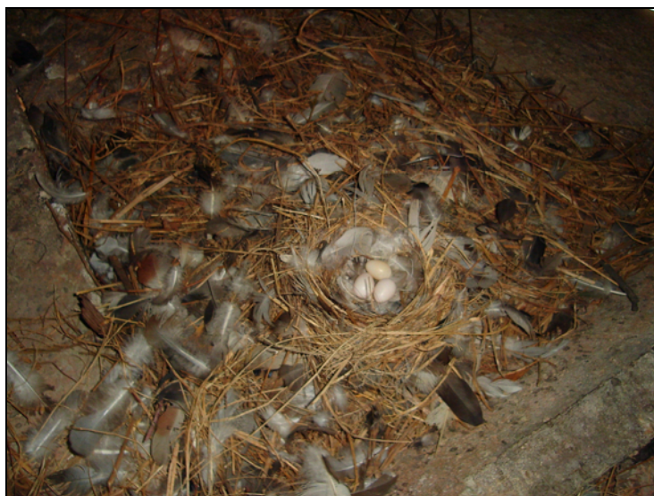
Figura 5.14b – Ninho de ave dentro de uma das galerias, sobre a tampa da janela de inspeção (galeria GB 74)
