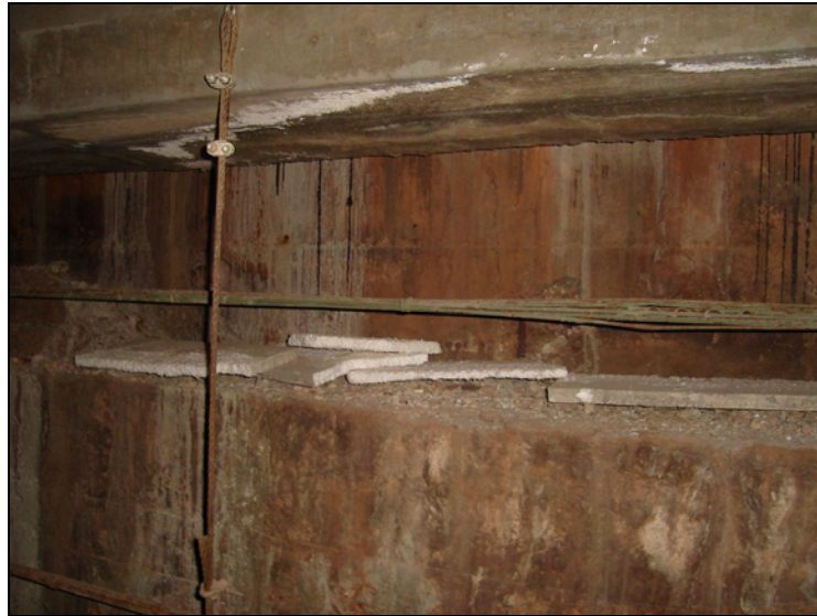
Figura 5.32 – VT sem sinais de que foram realizados reparos (galeria GB 41)
