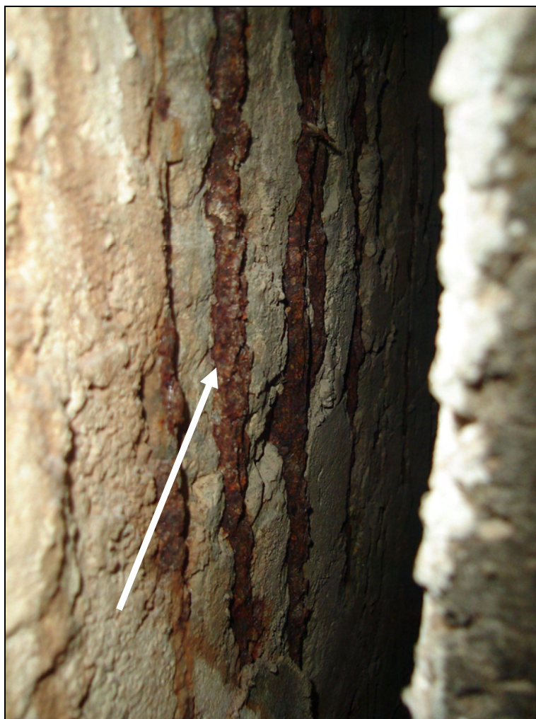
Figura 5.66 – Armaduras da VT, na interface com a longaria, expostas (galeria GA 57)
