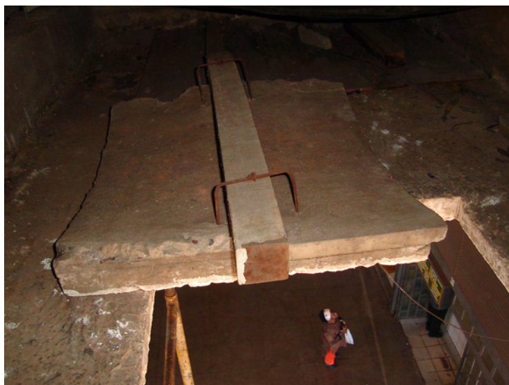
Figura 5.55 – Tampa da janela de inspeção danificada (galeria GA 13)
