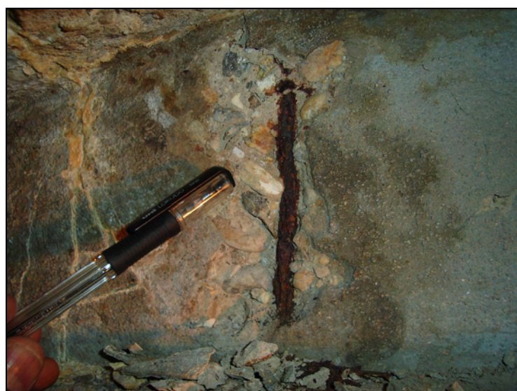
Figura 5.30 – Armadura da VS exposta devido à corrosão e desagregação do concreto (galeria GB 37)
