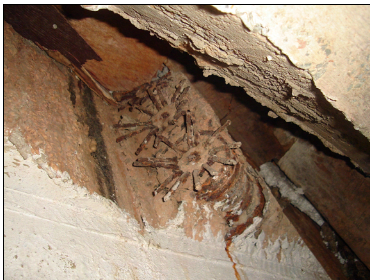
Figura 5.35 – Cones de ancoragem com fortes sinais de corrosão (galeria GB 29)
