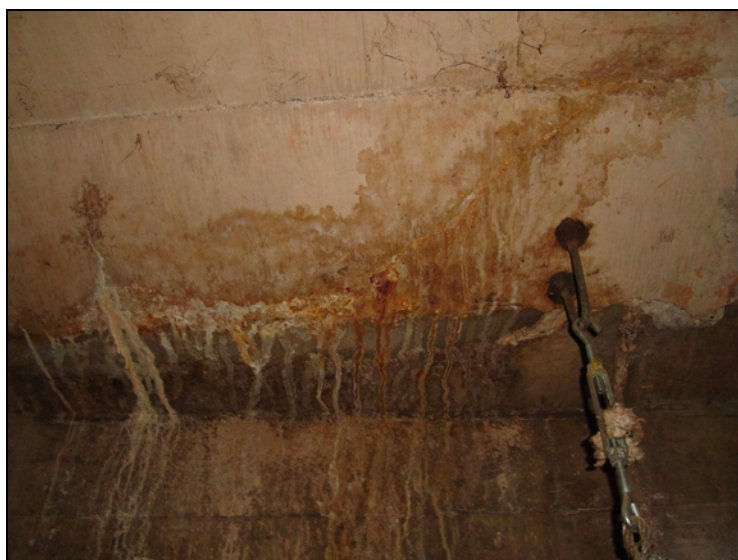
Figura 5.37 – Sinais de infiltração pela fissura que sofreu trabalhos de reparos (galeria GB 28)
