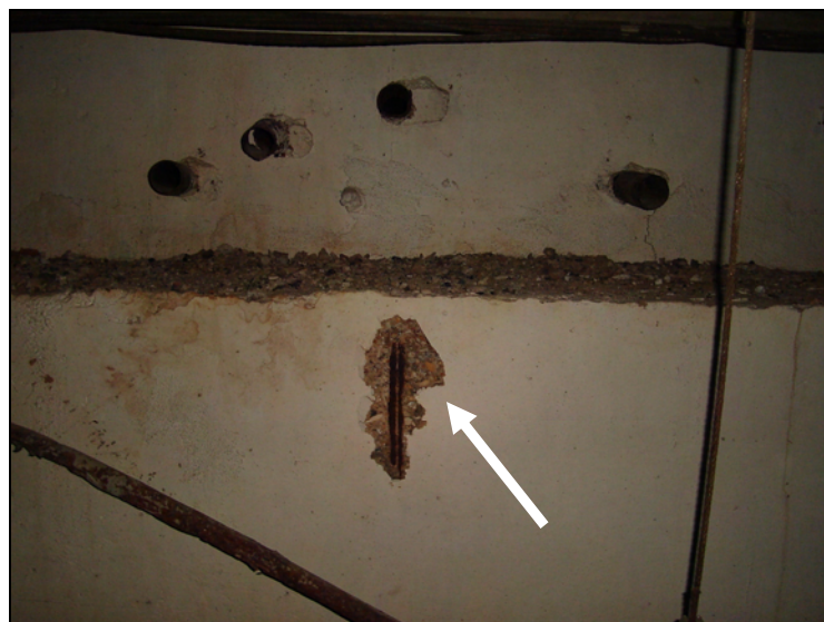
Figura 5.43a – Concreto superficial da VT desagregado e sua armadura exposta – visão ampla (galeria GA 41)
