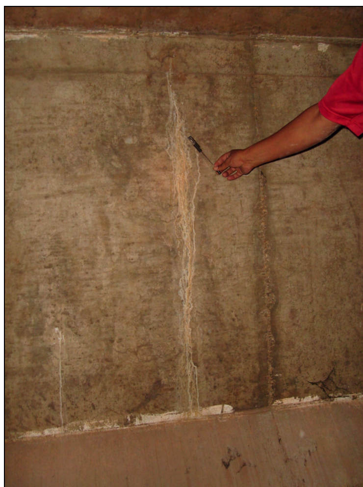
Figura 5.12 – Eflorescência na parte central da Longarina (galeria GB 86)
