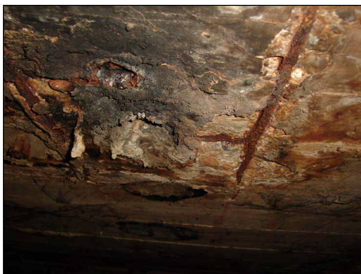
Figura 5.49 – Intervenção antiga com armaduras expostas e corroídas (galeria GA 24)
