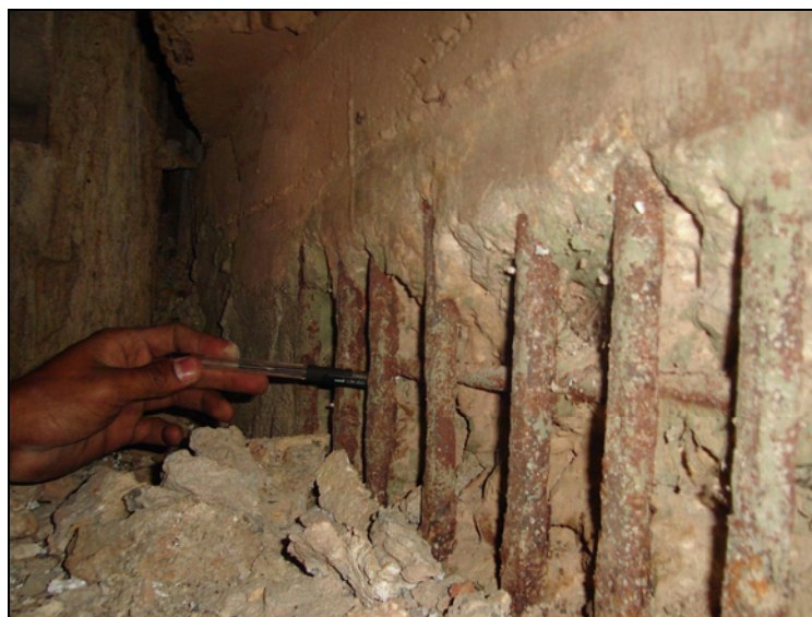
Figura 5.25 – Armaduras da VT expostas, imagem lateral (galeria GB 51)
