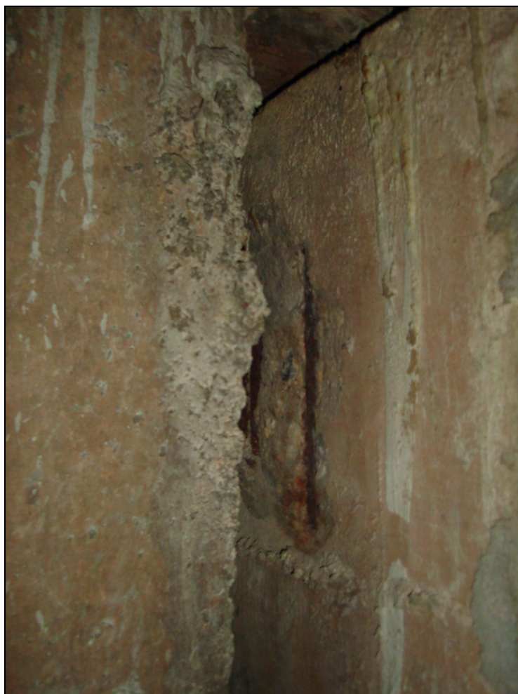
Figura 5.28 – Armaduras da VT expostas junto à interface com a Longarina (galeria GB 49)
