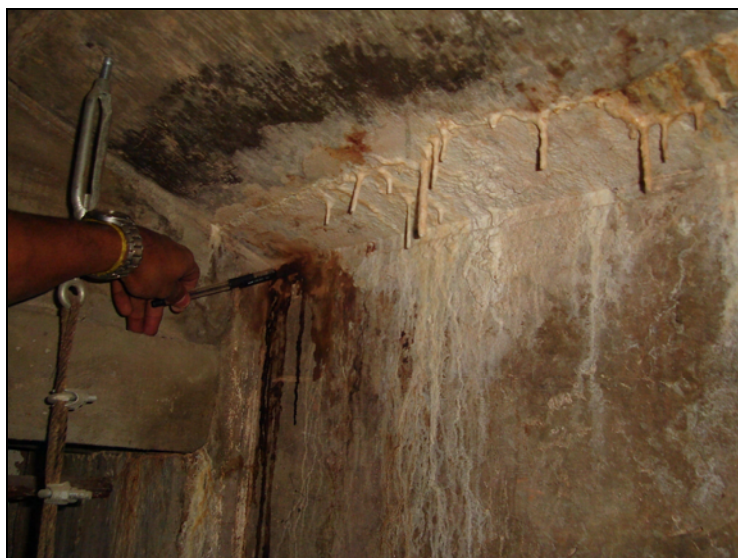
Figura 5.21 – Fortes sinais de infiltração entre a longarina e a laje superior, com formação de estalactites de aproximadamente vinte e um centímetros (galeria GB 51)
