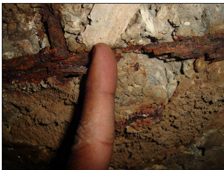
Figura 5.52b – Seccionamento de um cabo de protensão da laje superior devido ao processo de corrosão (galeria GA 14)
