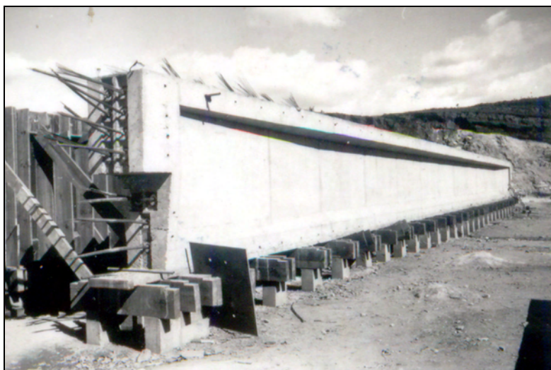
Figura 2.16 – Longarinas no canteiro de obra concretada (Arquivo Público, data e autor não identificados).
