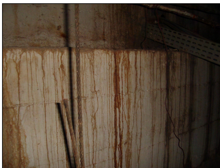
Figura 5.15b – VT com fortes sinais de infiltração, visão mais aproximada (galeria GB 73)
