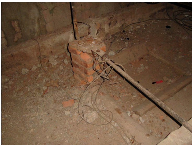
Figura 5.27 – Bloco de alvenaria sobre a tampa da janela de inspeção da galeria, impossibilitando o acesso por esse local (galeria GB 50)
