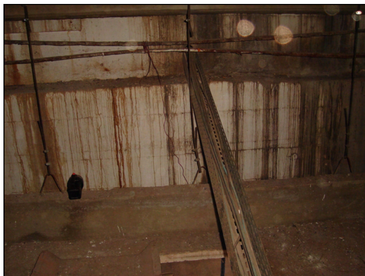
Figura 5.15a – VT com fortes sinais de infiltração, imagem mais ampla (galeria GB 73)
