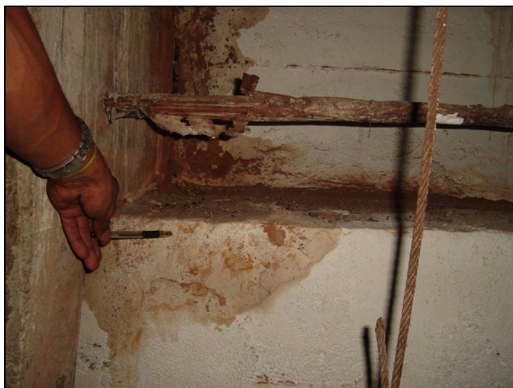
Figura 5.61 – Manchas sobre a superfície da VT demonstram indícios de infiltração (galeria GA 59)
