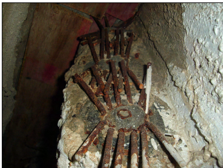
Figura 5.38 – Cones de ancoragem da VT expostos e com sinais de corrosão (galeria GB 27)
