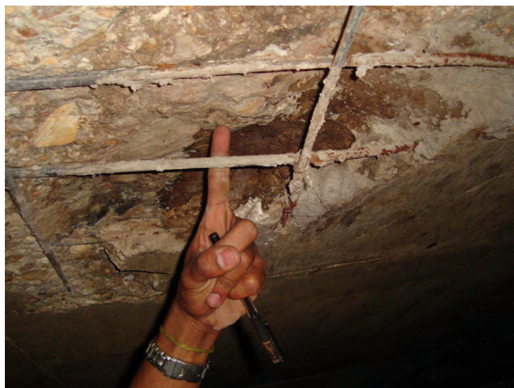
Figura 5.62b – Armaduras expostas devido ao ninho de concretagem sob a laje superior – visão aproximada (galeria GA 59)
