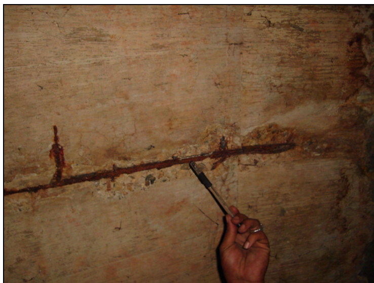
Figura 5.63 – Armadura da laje superior exposta e em processo de corrosão (galeria GA 58)
