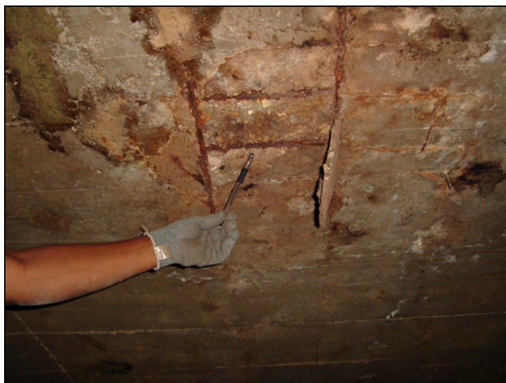
Figura 5.52a – Desagregação do concreto sob a laje superior com exposição de armaduras em processo de corrosão (galeria GA 14)
