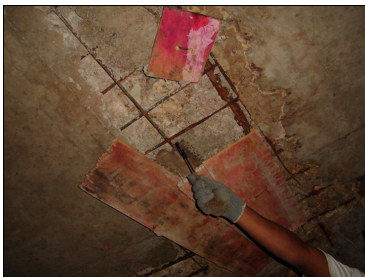
Figura 5.42 – Patologia na laje superior da galeria GA 51
