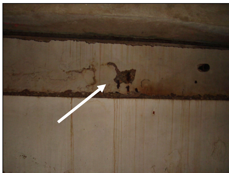
Figura 5.51a – VT com manchas de infiltração em sua superfície e desagregação do concreto com exposição de armadura em processo de corrosão – visão geral (galeria GA 14)
