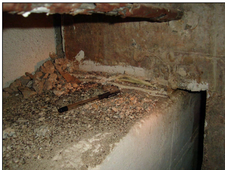
Figura 5.8 – Aparelho de apoio com aspecto de esmagamento e deformação lateral excessiva (galeria GB 75)
