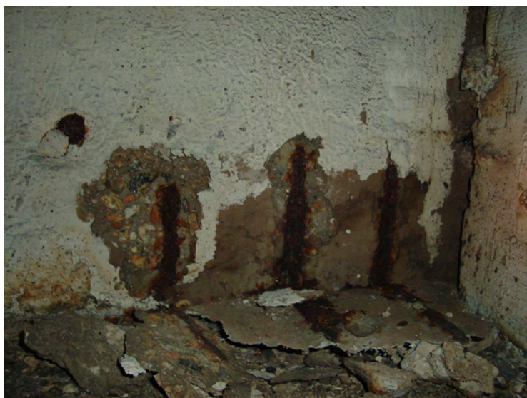
Figura 5.50 – Corrosão da armadura com deslocamento do concreto (galeria GA 19)
