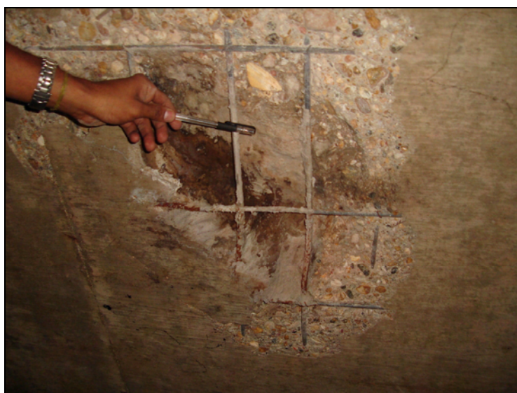
Figura 5.62a – Ninho de concretagem sob a laje superior com armaduras expostas – visão geral (galeria GA 59)
