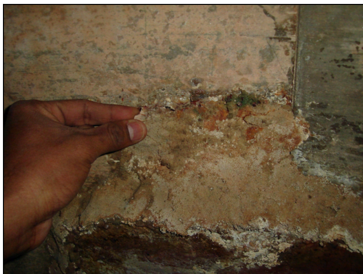
Figura 5.20 – Reparo antigo na laje superior sem aderência (galeria GB 61)
