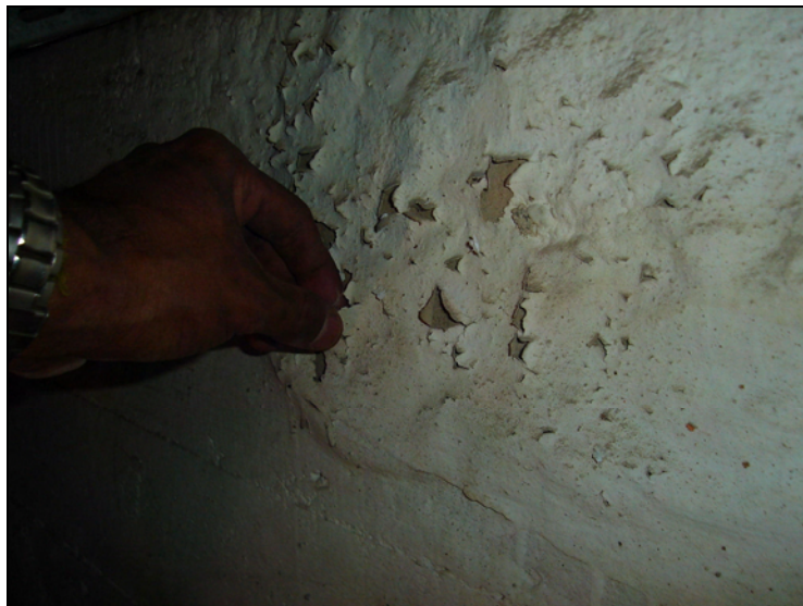
Figura 5.64 – Pintura protetora esfoliando (galeria GA 57)
