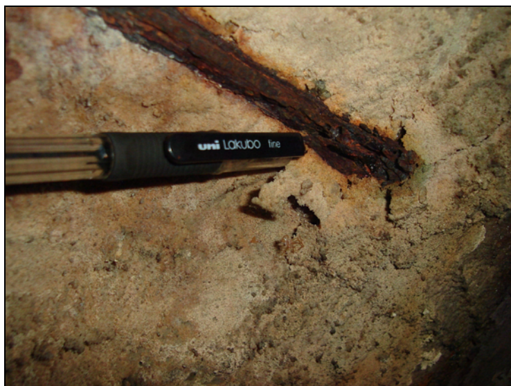
Figura 5.58 – Armaduras da laje superior corroídas (galeria GA 63)
