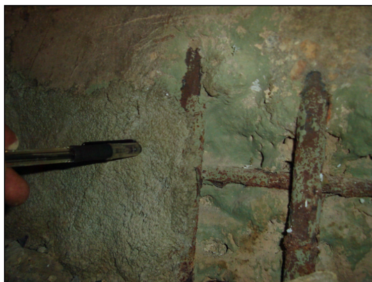
Figura 5.26 – Indícios de reparo antigo executado de forma incompleta (galeria GB 51)
