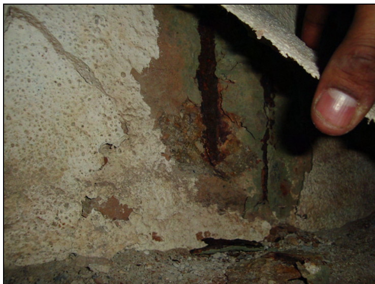
Figura 5.65a – O concreto superficial facilmente retirado com as mãos (galeria GA 57)
