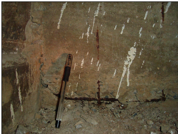
Figura 5.60 – Armaduras da VS em processo de corrosão (galeria GA 60)
