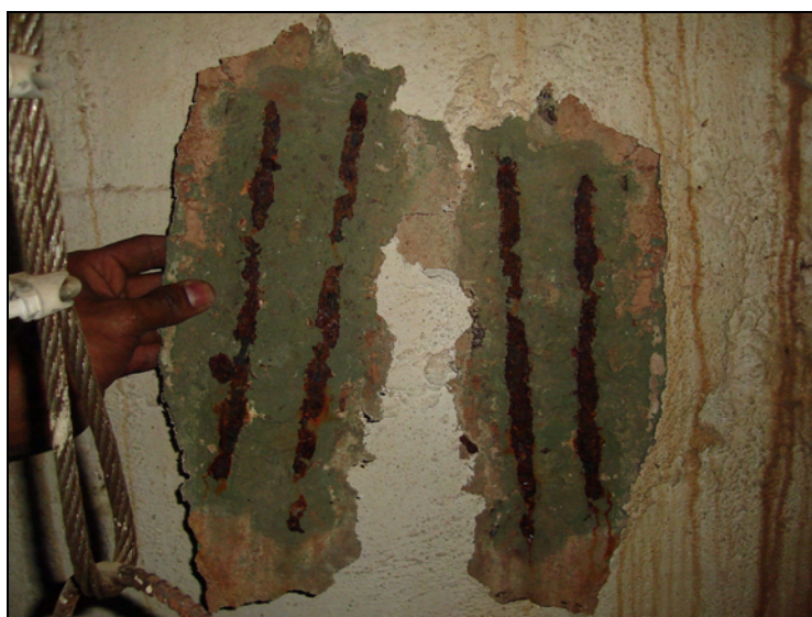
Figura 5.65c – Localização da desagregação do concreto – visão aproximada (galeria GA 57)
