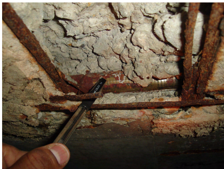
Figura 5.41 – Armaduras corroídas e seccionadas em reparo antigo sob a laje superior (galeria GA 51)
