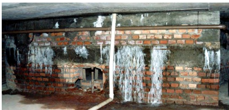
Figura 2.22 – Eflorescência em alvenaria de deck de piscina de edifício residencial em Goiânia – GO
