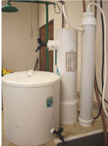
Figura 3.14 – Sistema de deionização / filtração
