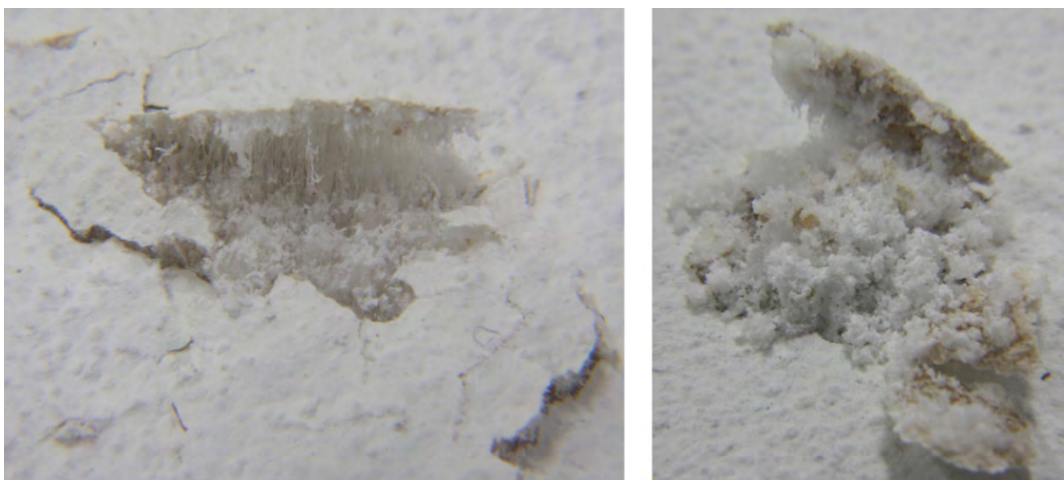
Figura 4.54 – Ruptura da película de barreira devido à cristalização de sais, característicos da Fase III e da Fase V da thenardita, em sua interface com o revestimento de argamassa
