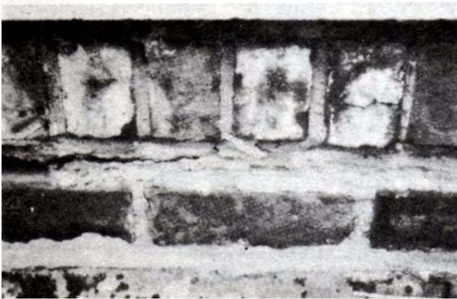
Figura 2.16 – Eflorescência em juntas de alvenaria aparente com fissuração horizontal por efeito de expansão da argamassa de assentamento (subflorescência) (UEMOTO,1988)
