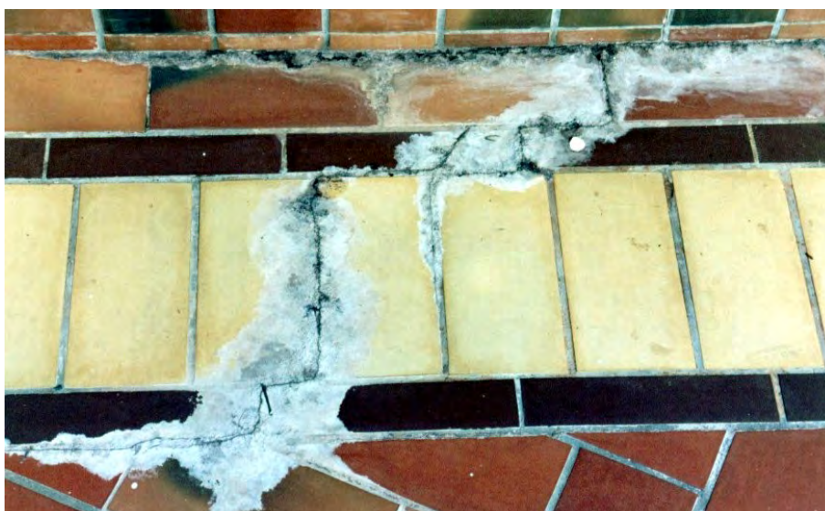
Figura 2.13 – Florescência em junta de assentamento de revestimento cerâmico com fissuração provocada por expansão na argamassa - criptoflorescência
