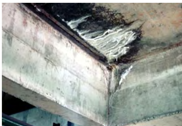
Figura 2.15 – Eflorescências provocadas pela lixiviação do hidróxido de cálcio em laje de edifício comercial em Brasília – DF
