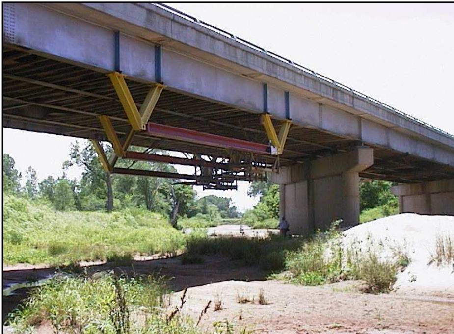
Figura 2.2 – Amortecedores de orifício variável instalados na ponte Walnut Creek na estrada interestadual I35 nos Estados Unidos (Yang, 2001).
