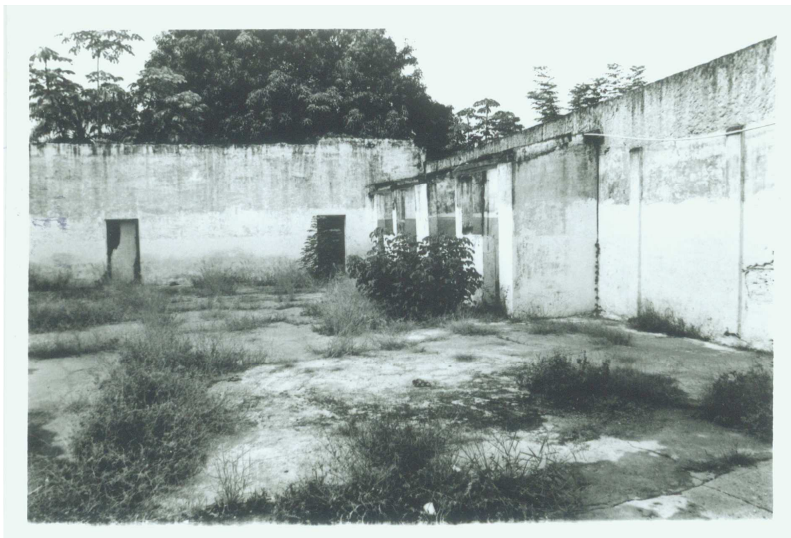
FOTO 1 – Paredes remanescentes da construção da Chácara dos Loucos, Cuiabá, 5/9/1969. Fonte: SECRETARIA DE ESTADO DE SAÚDE DE MATO GROSSO, 1969
