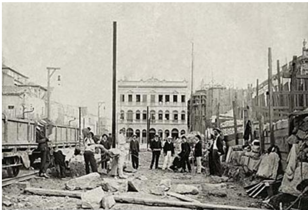
Demolições para a construção da avenida Central, 1904-1905 João Martins Torres – Acervo Instituto Moreira Salles
